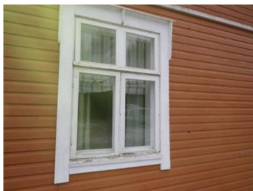
8. Ikkunassa ei vesipeltejä
