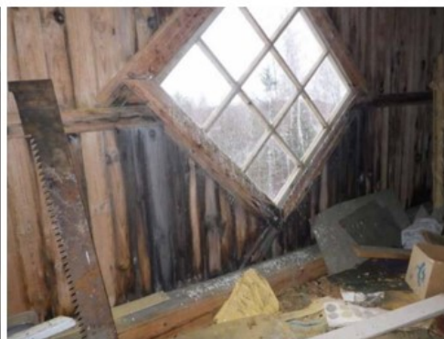
13. Ikkunan kohdalla kosteusvauriota
