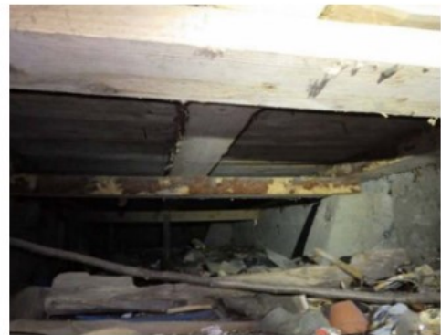
6. Ryömintätilassa rakennus- ja muuta jätettä
