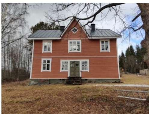
10. Sadevesikourut ja syöksytorvet puuttuvat
