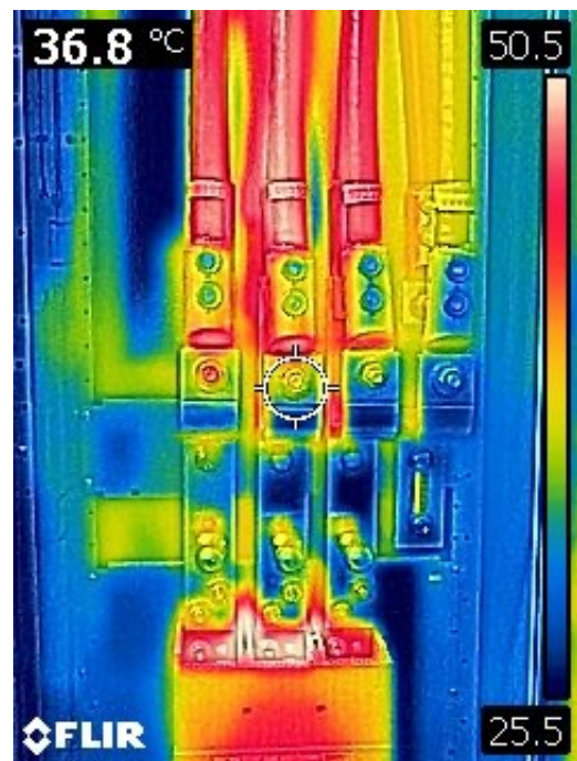
KUVA 9. Keskuksen lämpökuva (Laitila 2018)
