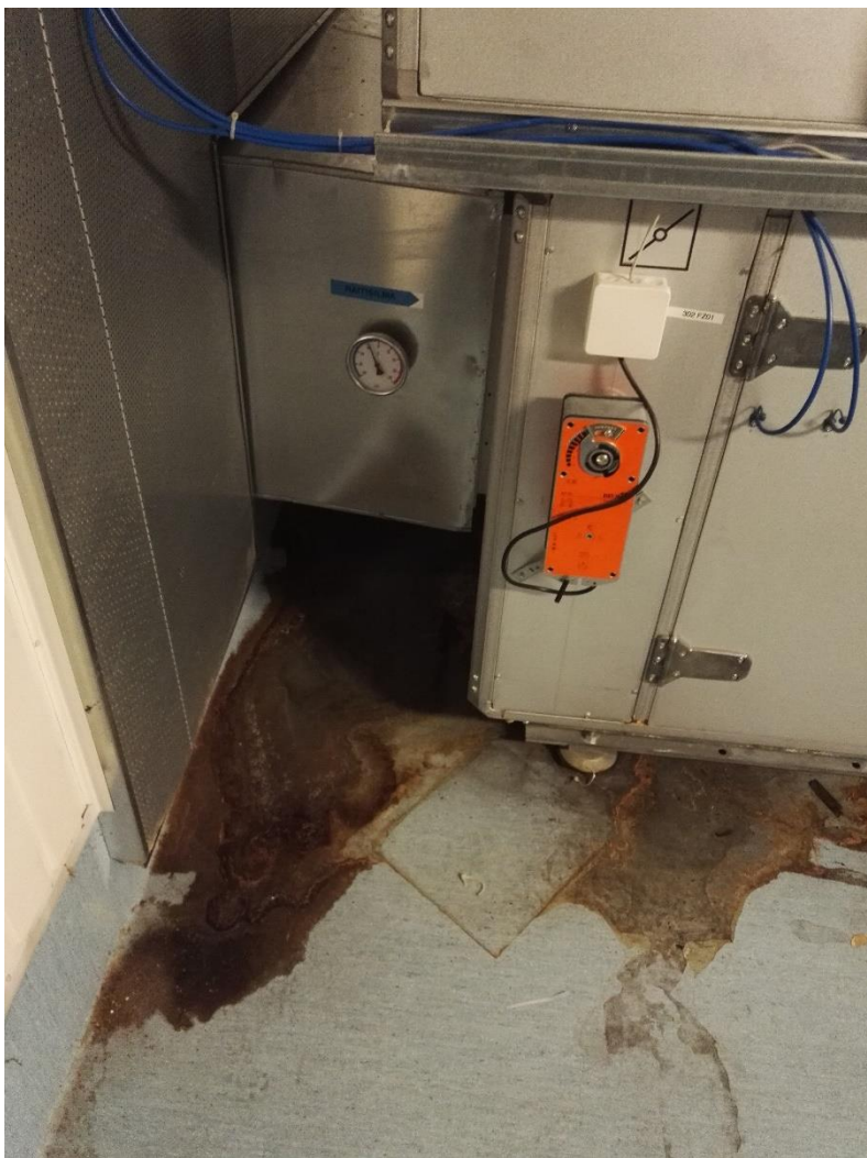
KUVA 3. Ilmanvaihtokoneeseen päässyt kosteus valunut myös koneen ulkopuolelle
