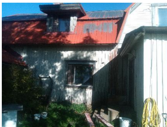
Figur 16. Värsta väggen på butikshuset.
