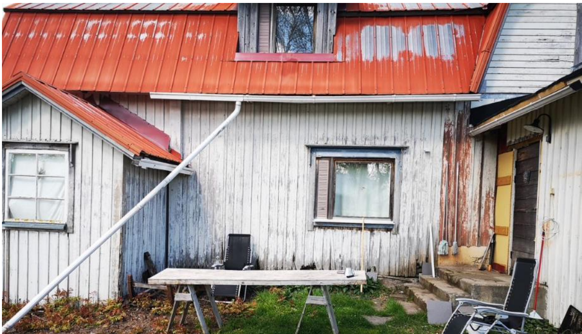
Figur 29 Husets värsta fasader, taget på södra sidan av huset.
