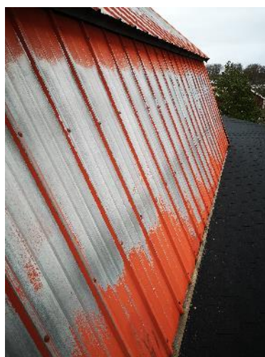
Figur 19. Nästan all färg har lossnat från plåten
