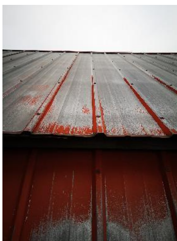
Figur 18. Slitage på plåttak.
