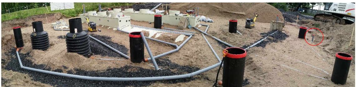
Kuva 3. Panoraamakuva viemäroinneistä. Kuvassa vasemmalta lähtien yhdyskaivo, NOK ja ÖBE. Etualalla ilmasulkukaivoja ja taaempana hiekanerotuskaivoja. Oikeassa reunassa ympyröitynä kalvokaivo.
