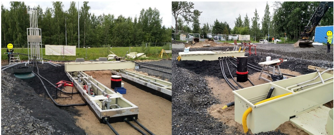
Kuva 6. Vasemmassa reunassa putkipatteri. Vasemmassa kuvassa avonaisten huoltokuilujen päällä TS:n mittarinaluslaatikko. Oikeanpuoleisessa kuvassa kaksi muuta mittarinaluslaatikkoa. Mustat putket ovat Secon-X-putkia.
