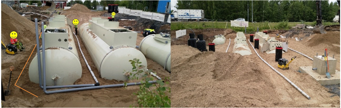
Kuva 2. vasemmalla alemmat huokosilmaputket. Kuvaan merkitty oranssilla vasemmalta säiliön vierestä puuttuva putki. Oikeanpuoleinen kuva. Ylemmät huokosilmaputket.
