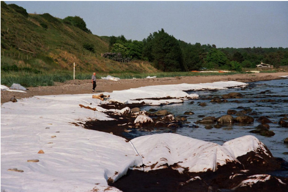
Kuva 2. Öljyn pysäyttäminen veteen välttämällä rantamateriaalin kontaminoitumista vähentää rantakeräyksen ja -puhdistuksen työmäärää, aikaa ja kustannuksia. (Kuvat: Sydöstra Skånes Räddningstjänst)
