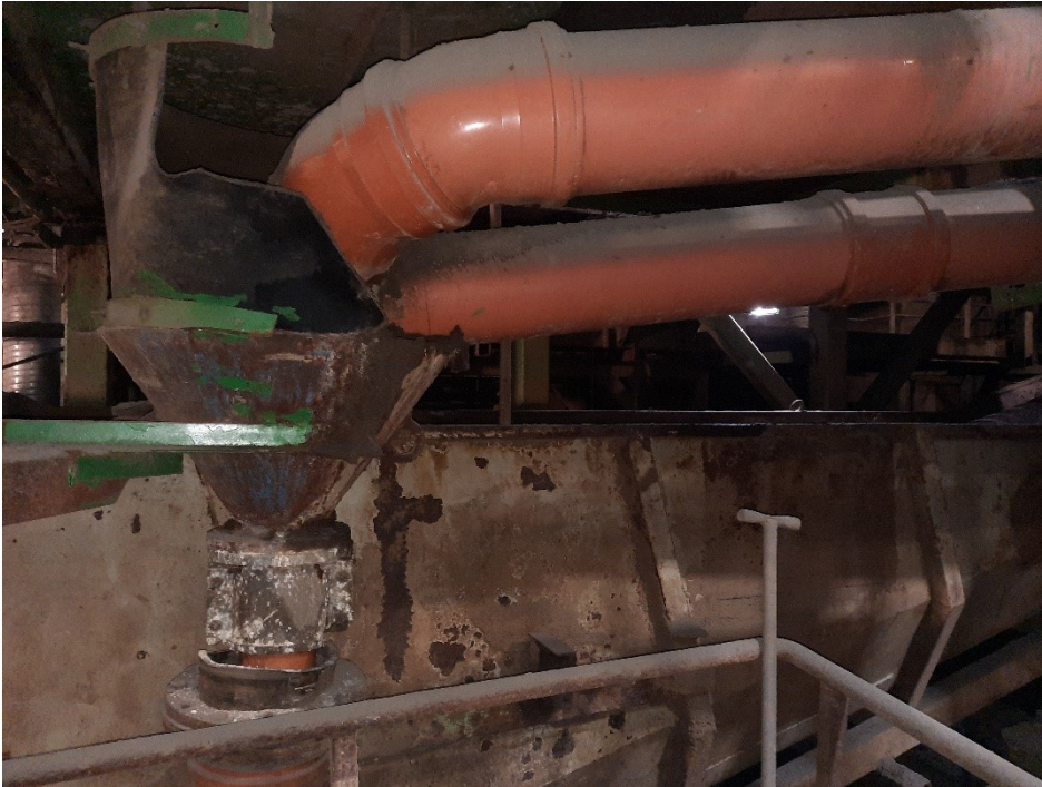
Kuva 16 Putkien yhdistymiskohta ja suppilo täryseulan ja saostusaltaan välillä
