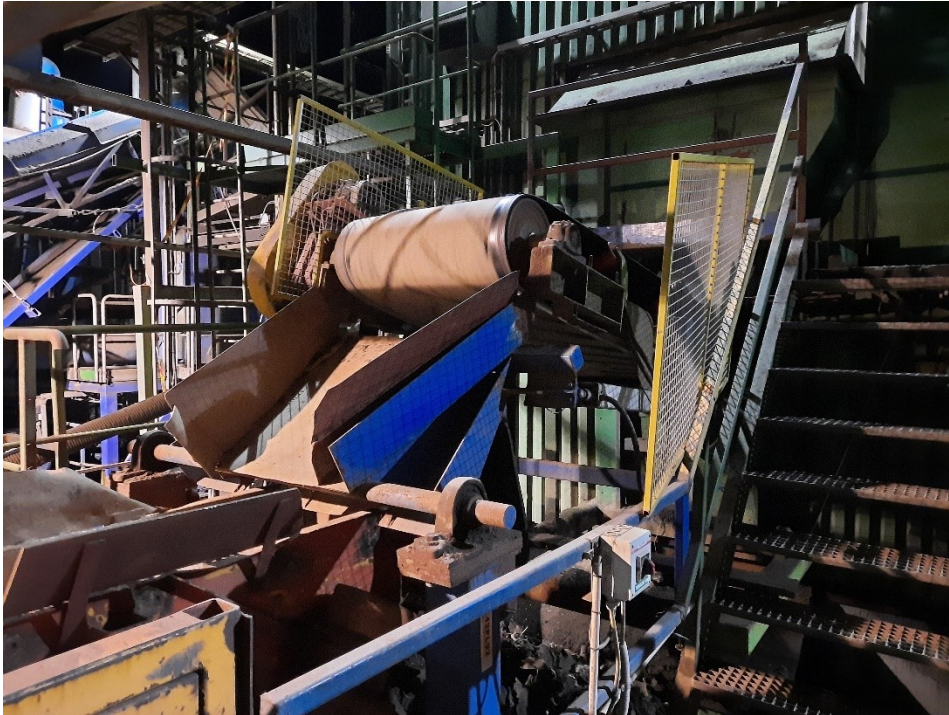
Kuva 7 Ylitekuljettimen sylinteritoiminen luiska
