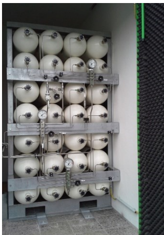
Kuva 3. Paineistettuja kaasupulloja biokaasun tankkausasemalla. Kaasu voidaan siirtää laitokselta tankkausasemalle joko putkilinjaa pitkin tai pidemmälle kaasupulloina © Pekka Alho
