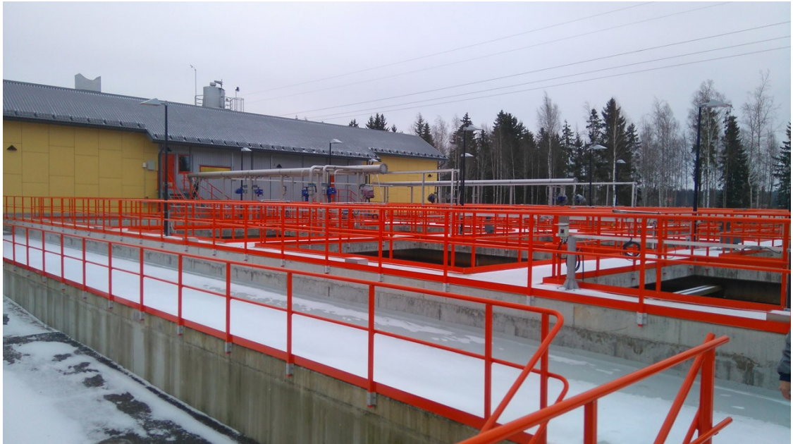
Kuva 1. Merkittävä osa Suomen biokaasulaitosten raaka-aineesta on peräisin jätevedenpuhdistamoilta. Loimaan uuden jätevedenpuhdistamon lietevesien biokaasupotentiaali tutkittiin Circwaste Life -hankkeessa Turun ammattikorkeakoulun toimesta. Tulosten perusteella Loimaan jätevesilietteet soveltuisivat varsin hyvin biokaasun tuotantoon © Pekka Alho
