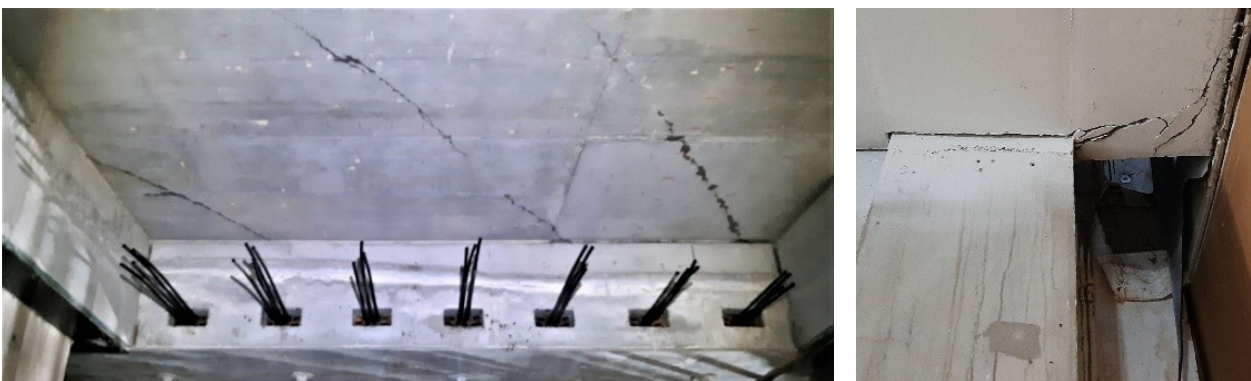
Kuvat 69-70 Puuttuvista irrotuskaistoista aiheutuneita holvin halkeamia.
