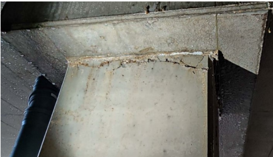
Kuva 20 Puutteellisesta laakerista johtuva halkeama pilarissa laakerin alapuolella (Kankaanpää, 2020, s. 10)
