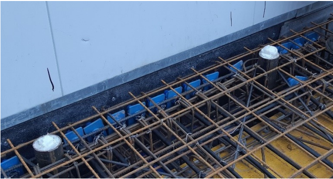
Kuva 65 Pysyvä irrotus katukansien liitoksessa: uretaanivahto irrotusputkien sisällä.
