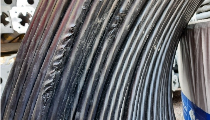
Kuva 100 Rikkoutunut punoksen suojaputki.
