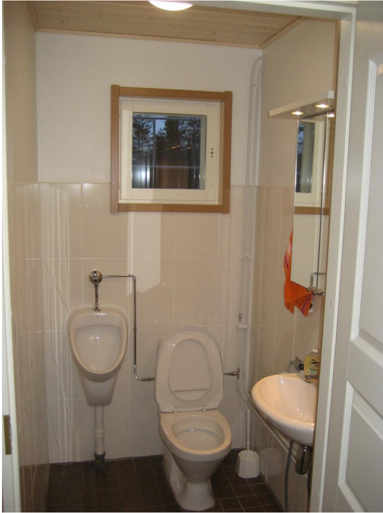
KUVA 6. Vessaan asennettiin yksityiskoteihin harvinainen urinaali
