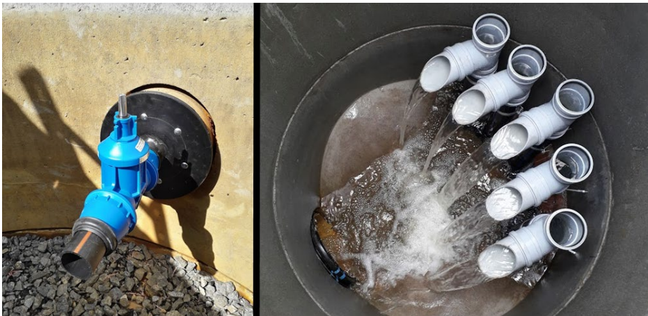
KUVA 2. Pitkäjärven hulevesijärjestelmän kevään 2020 muutostöiden tuloksia. Vasemmalla suodatinkaivoissa oleva säätöventtiili, josta tulovirtaamaa voidaan säädellä kaivokohtaisesti. Oikealla kokoojakaivosta kaikkien viiden suodatinkaivon korotetut poistoputket, jotka estävät vesien sekoittumisen ja mahdollistavat helpomman tutkimustyön. (kuva Aki Mykkänen)
