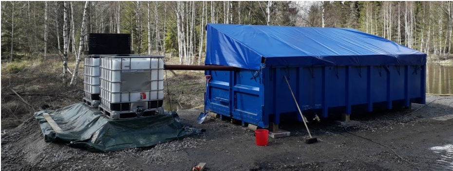
KUVA 5. Kevään 2020 muutostöiden jälkeinen Ristiinan vanhan kaatopaikan biosuodatuslaitteisto. Vasemmalla kaksi IBC-konteista tehtyä esiselkeytysallasta. (kuva Aki Mykkänen)
