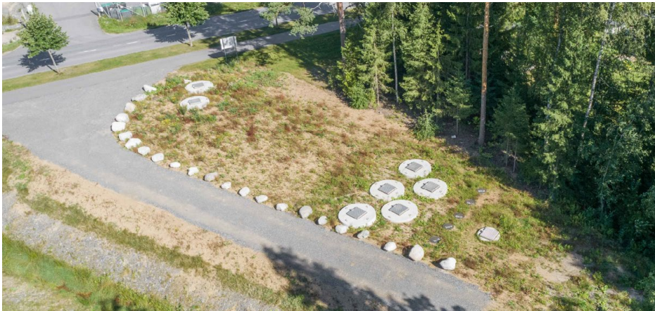
KUVA 1. Pitkäjärven hulevesijärjestelmä. Keskellä näkyvät viisi vierekkäistä kaivoa sisältävät suodatinmateriaalit. (kuva Juha Vihavainen)
