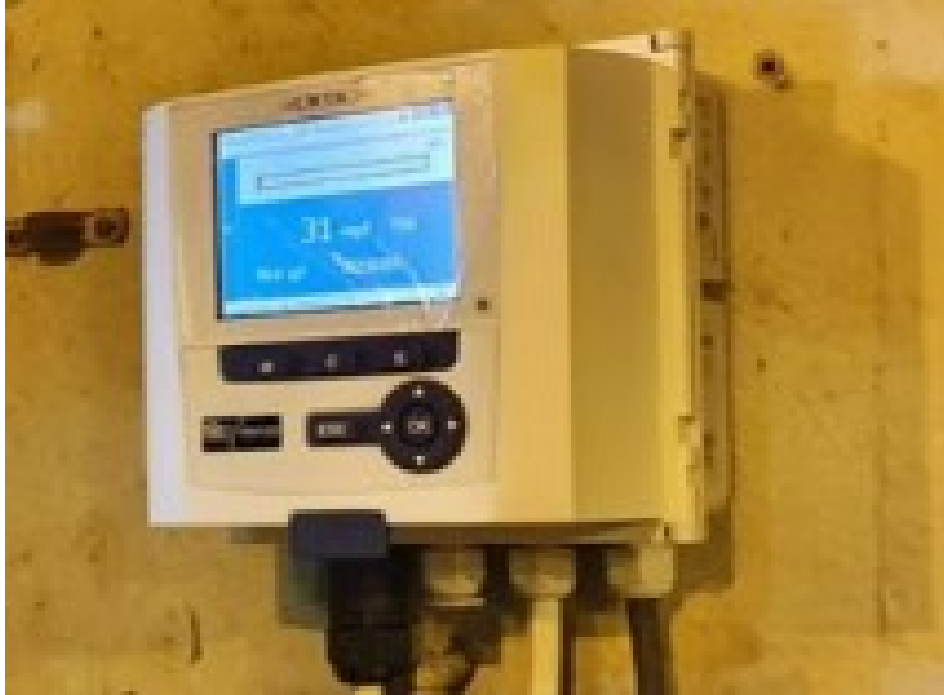
Kuva 9. Suodoksen laadun online-mittaus
