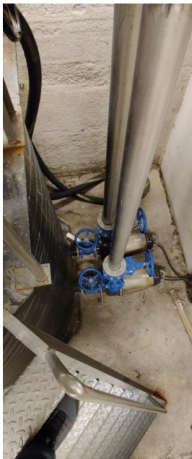
Kuva 23. Kaivo ja sen pumput
