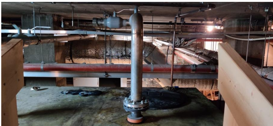
Kuva 14. Rasvanerotuskaivolta lähtävä tyhjennysputki
