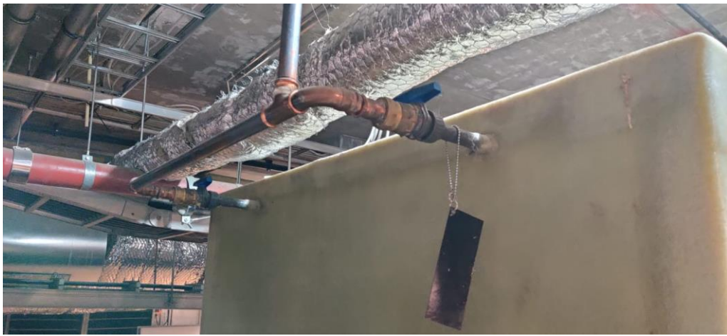
Kuva 9. Rasvanerotuskaivon pesujärjestelmien syötöt
