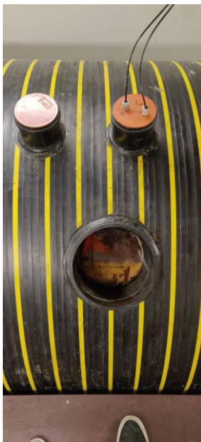
Kuva 31. Rasvanerotuskaivon tarkastusluukku pinta-anturin kohdalla
