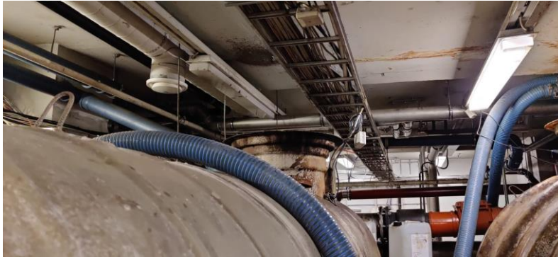
Kuva 28. Rasvanerotuskaivon huoltoluukun vähäinen tila yläpuolella
