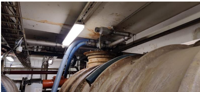
Kuva 29. Rasvanerotimen huoltoluukun vähäinen tila
