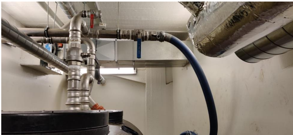
Kuva 15. Rasvanerotuskaivon tyhjennysputki ja siihen liitetty tyhjennysletku
