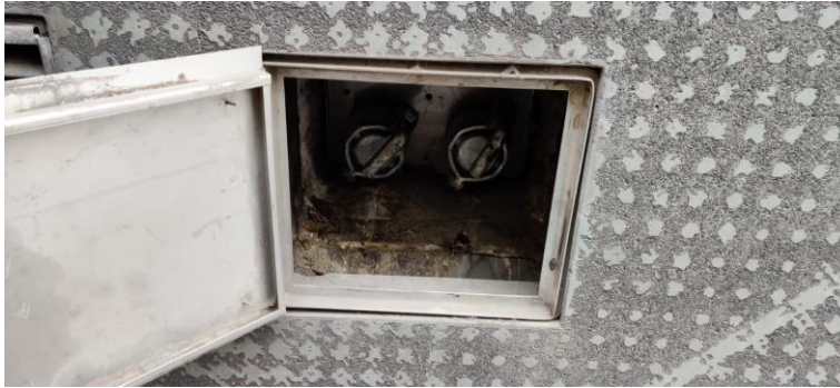
Kuva 19. Tyhjennysimuputkien liitokset luukun takana
