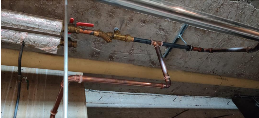
Kuva 11. LV-liitos rasvanerottimelle ja liitos pesuletkulle
