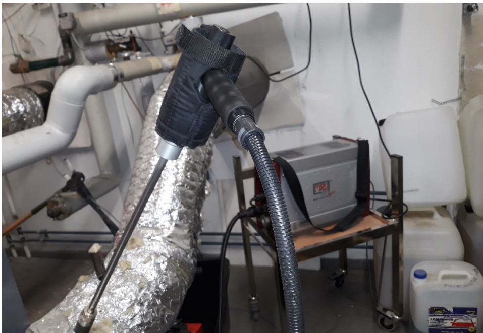
Kuva 3. Savukaasuanalysaattori MRU Vario Plus asennettuna savukanavaan (Pesonen 2020)
