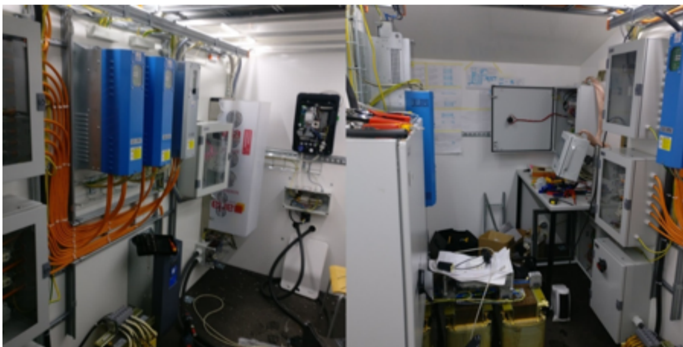
KUVA 2. Energiajärjestelmän sähkötekniistä toteutusta kuvassa 1 esitetyn latausperävaunun sisältä.
