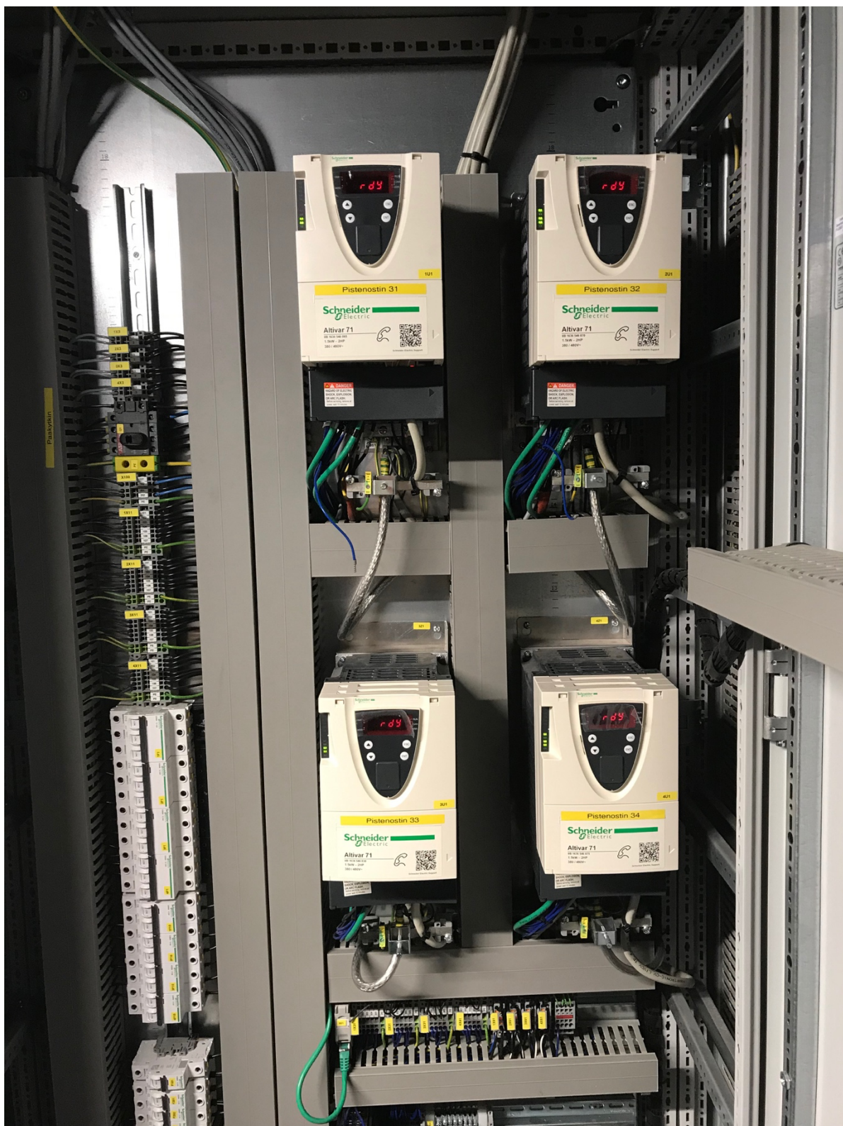
Kuva 3. Pistenostimen ohjauksen sähkökaappi sisältä.
