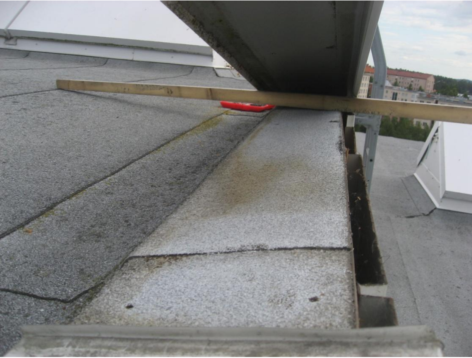
Kuva 32. Kermi ei ulotu räystäällä seinälinjan yli, vesi pääsee julkisivukasetin välistä kotelorakenteeseen. Kuva Petteri Kuokkanen
