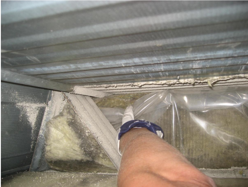
Kuva 27. Seinän höyrinsulku ei liity yläpohjan höyrinsulkuun. Eristeissä ilmavuodon aiheuttamia tummumia, ks. myös detalji D103 (kuva 30). Kuva Petteri Kuokkanen
