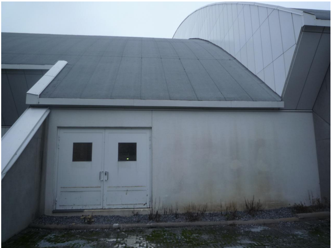
Kuva 24. Lumi ja jää putoavat poistumistien eteen. Kuva Petteri Kuokkanen
