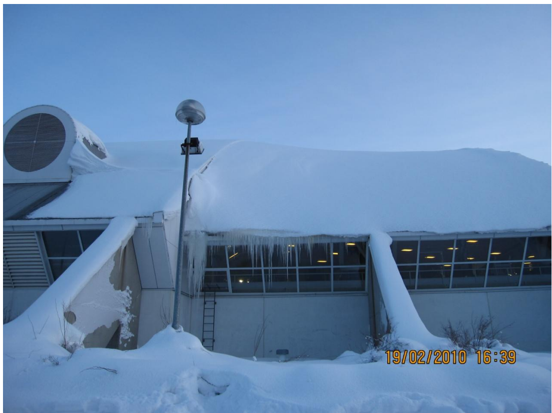
Kuva 12. Lunta ja jäätä kertyy runsaasti tasoerojen kohdalle. Kuva Kuopion kaupunki, Tilakeskus
