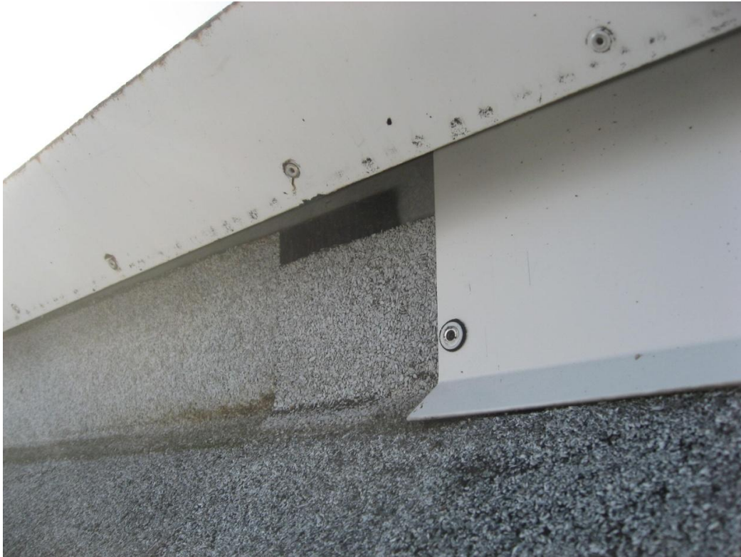
Kuva 18. Savunpoistoluukun kermin ylösnosto on liian matala. Kuva Petteri Kuokkanen
