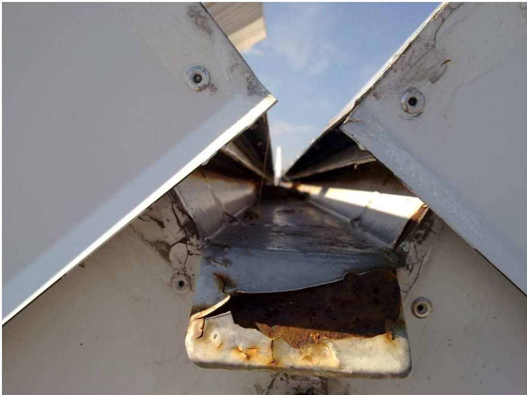
Kuva 19. Savunpoistoluukun vedenpoistokouru on ruostunut ja se kerää roskaa. Kuva Petteri Kuokkanen
