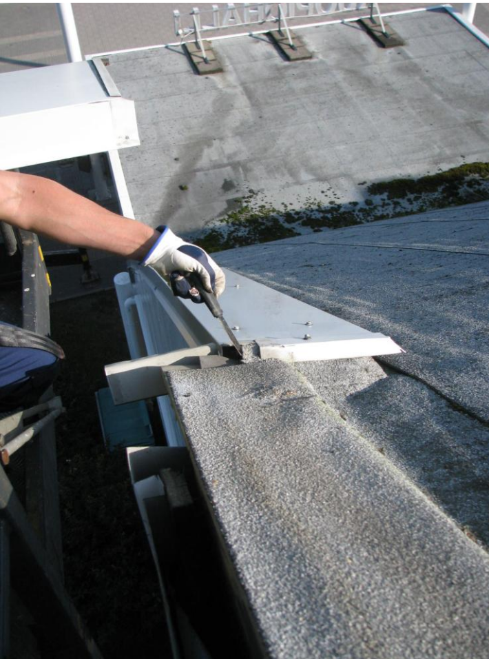
Kuva 33. Reikä räystääspellityksen alla. Kuva Antti Bäck
