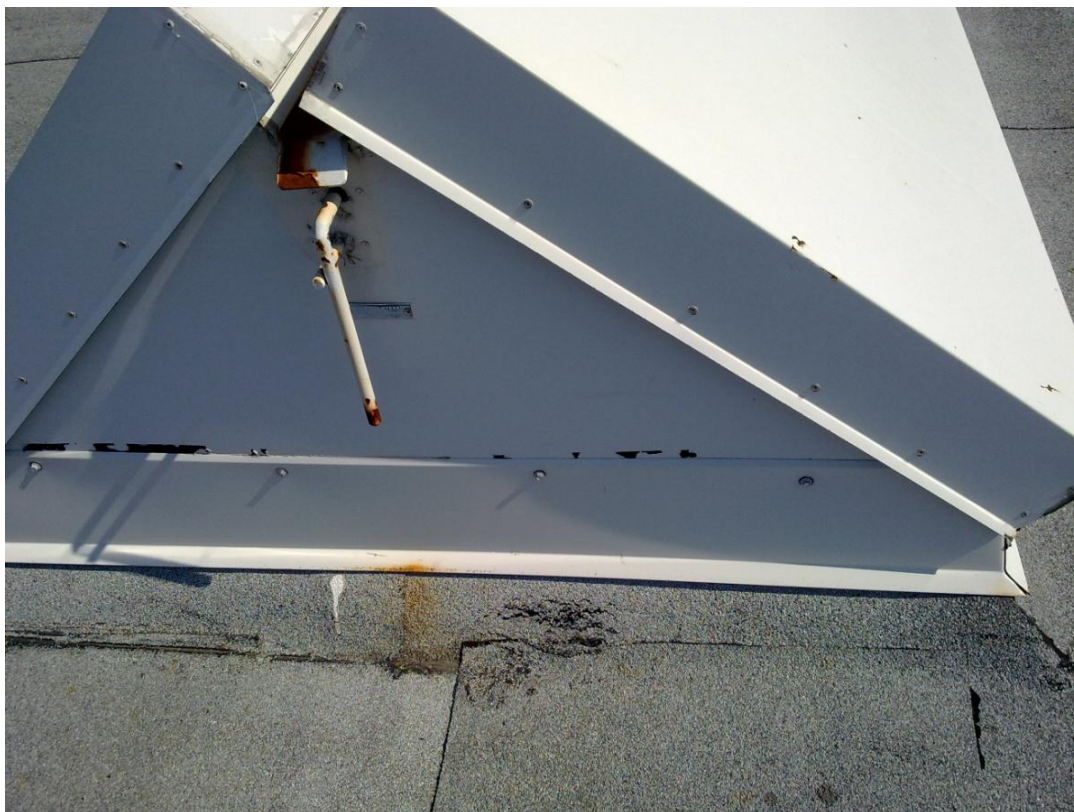
Kuva 20. Savunpoistoluukun alareunan vastapellitys on väärin päin. Kuva Petteri Kuokkanen
