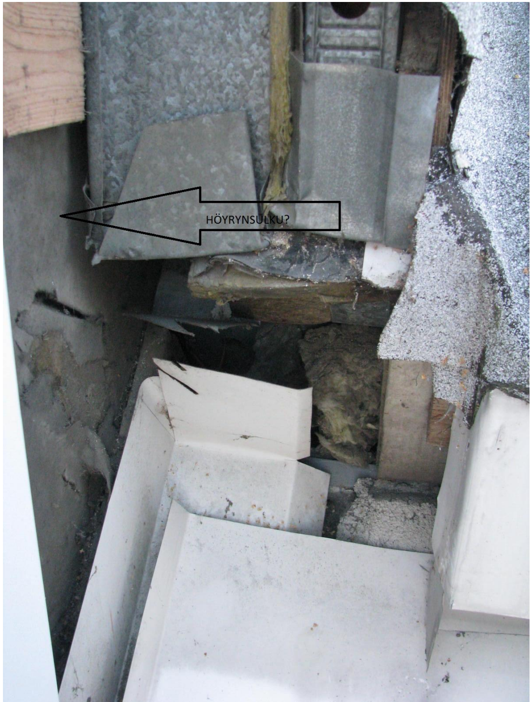
Kuva 25. Ulkoseinä tasoeron kohdalta. Rakenne ei noudata rakennetyypin US2 mukaista rakennetta. Höyrynsulkua ei näy kuvassa lainkaan. Kuva Antti Bäck
