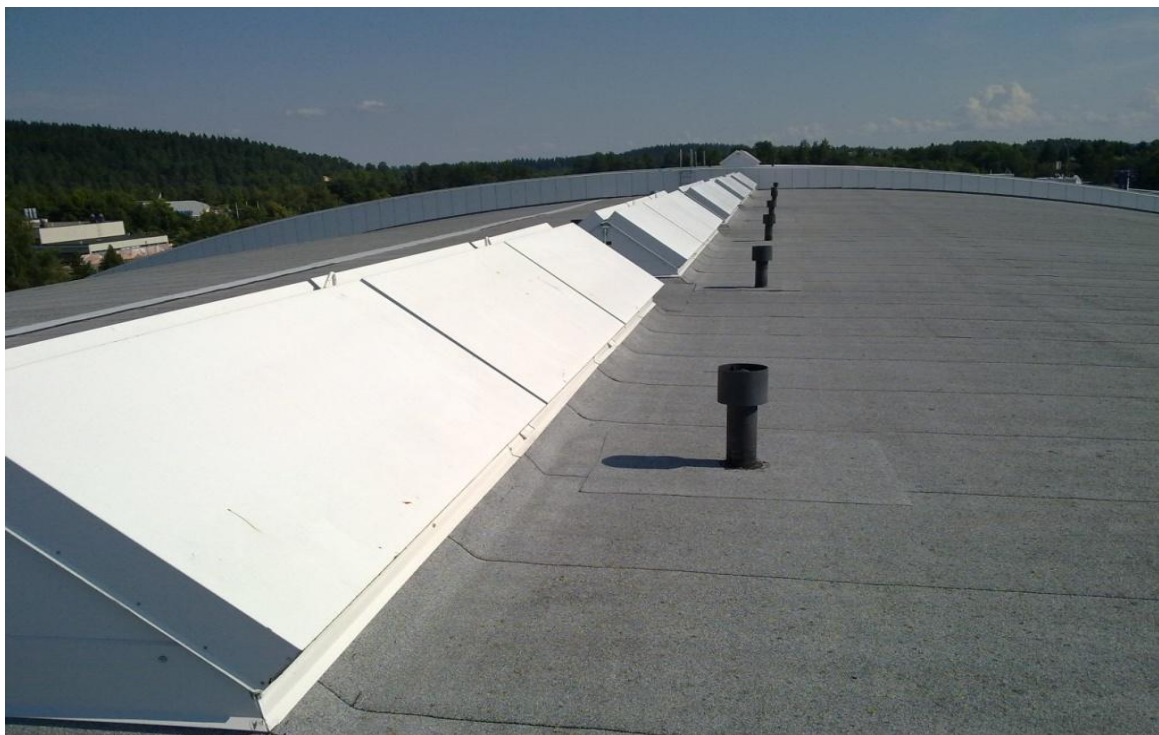
Kuva 17. Alipainetuulettimet ja savunpoistoluukut. Kuva Petteri Kuokkanen
