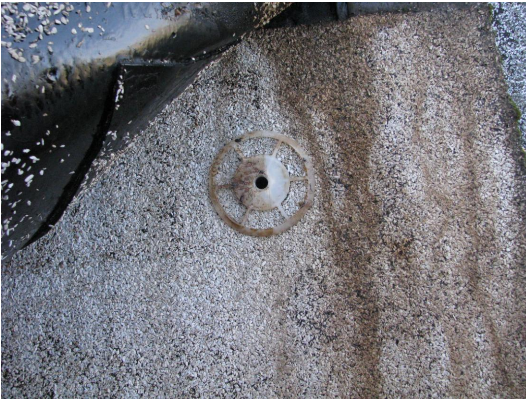
Kuva 22. Aluskermin mekaaninen kiinnike. Kermi on sirotteellinen. Veden valuma jälkiä havaittavissa kermissä. Kuva Petteri Kuokkanen
