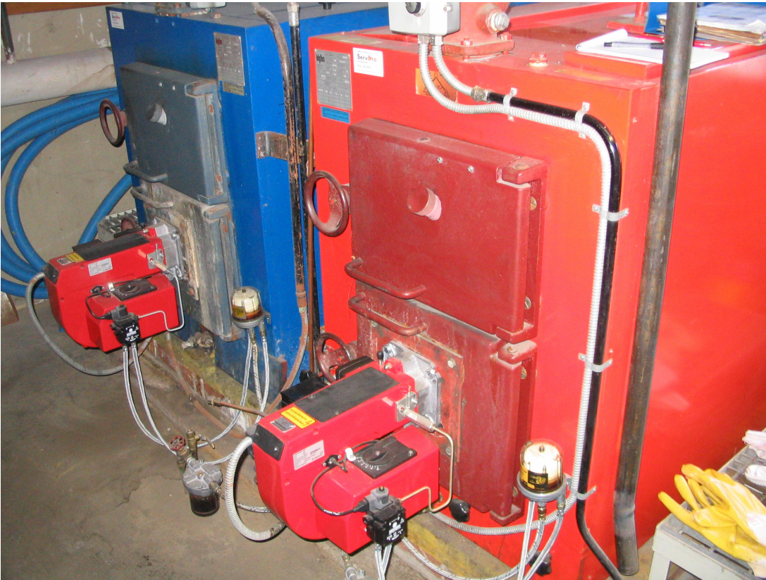
Kuva 5. Tehtaan öljykattilat ovat tyypiltään Högfors 20.
