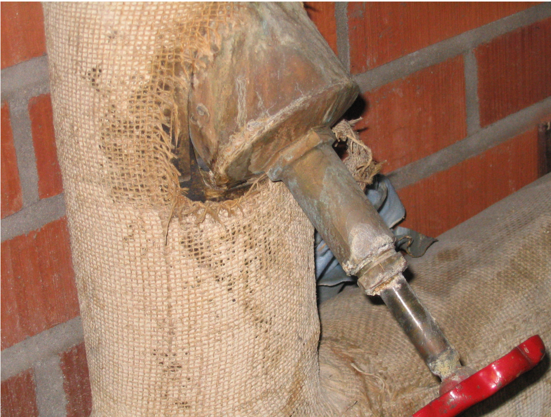
Kuva 7. Tämä pannuhuoneessa sijaitseva venttiili ei toimi.
