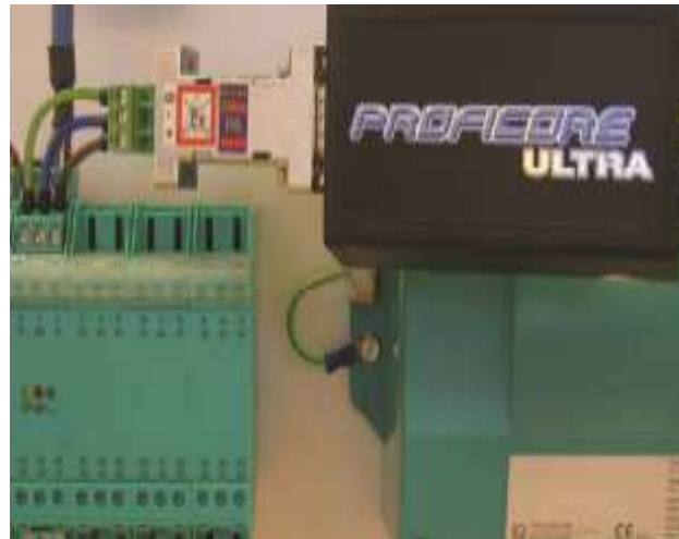
Kuvio 6. Laitteiston asennus PA-mittaukseen. (Procentec 2011, 34)
