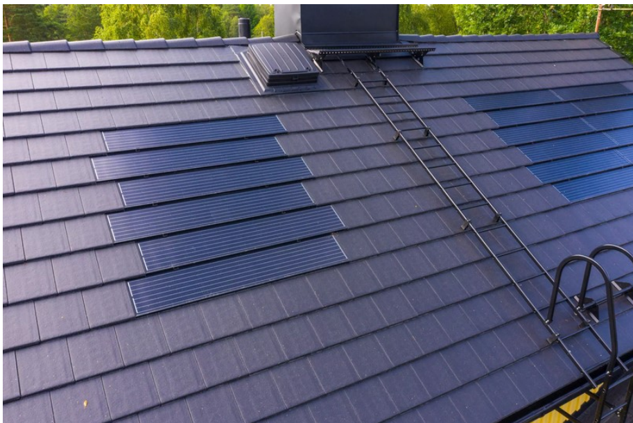
Kuva 15. Solarstonen aurinkopaneelit asennettu Ormax EVO -tiilikattoon (BMI Suomen www-sivut 2020)
