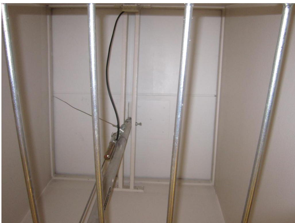
Figur 19. Automatiska rökluckor i taket på vinden.
