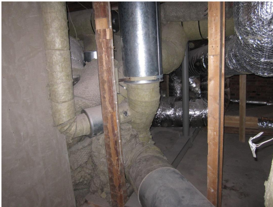
Figur 16. Stor del av vinden i gamla byggnaden upptas av rör för luftkonditioneringen.
