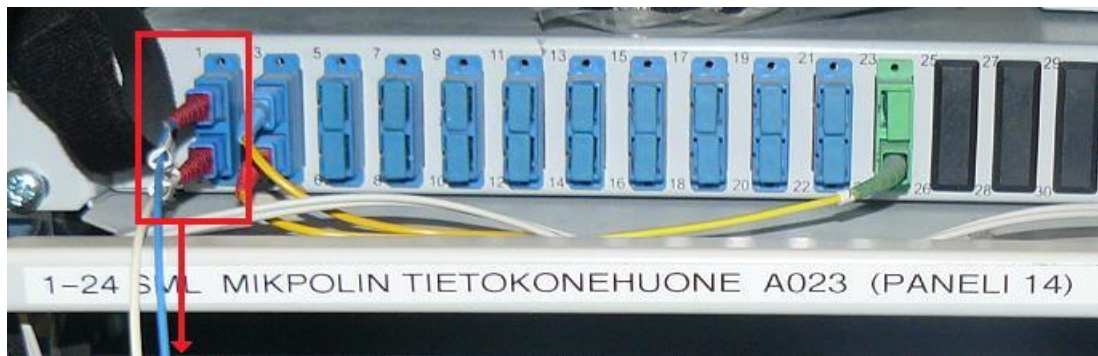
KUVA 12. E/D –jakamon kuitukytkentä
