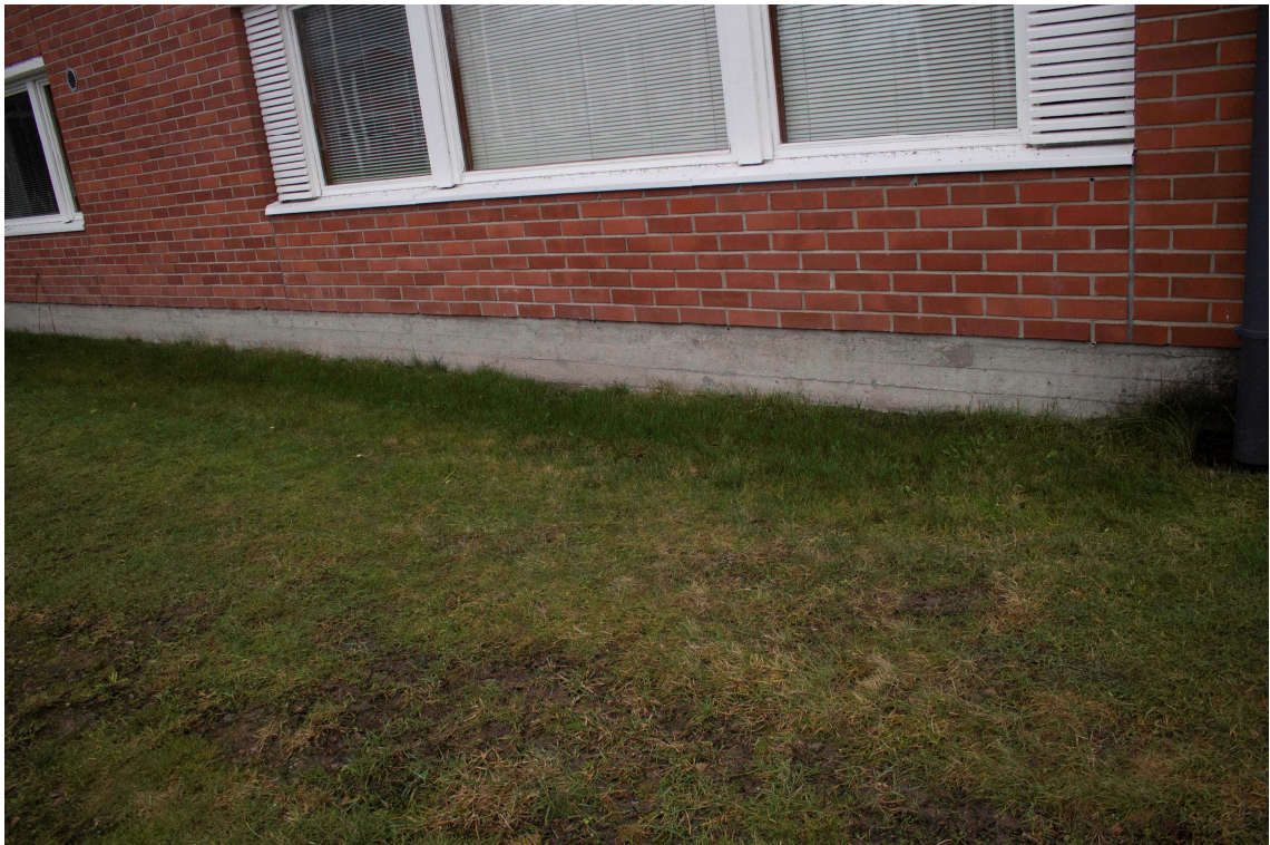
Kuva 10. Maanpinta rakennuksen reunustalla on osittain tasainen tai painunut rakennusta kohti. Lähde E. Vahala
