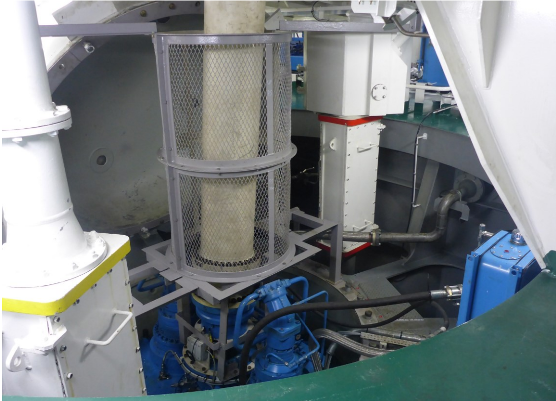
Kuva 22. Potkurilaitehuone ja suojaverkko (Peltonen sähköposti 1.10.2020)
