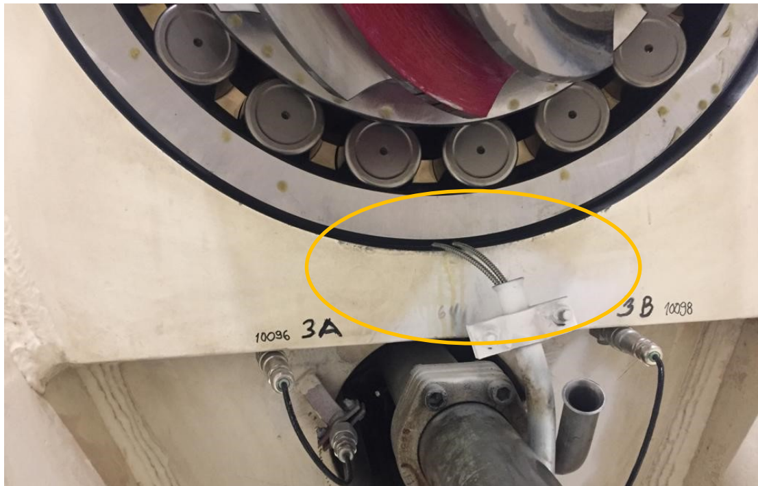
Kuva 17. Niskalaakerin valokuitukaapelien putkitus (Peltonen sähköposti 27.11.2020)
