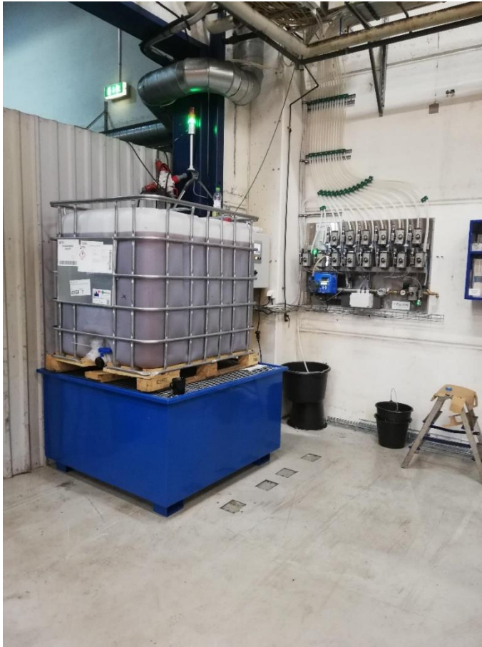
Kuva 8. Järjestelmä asennettuna (Vessari 2020).
