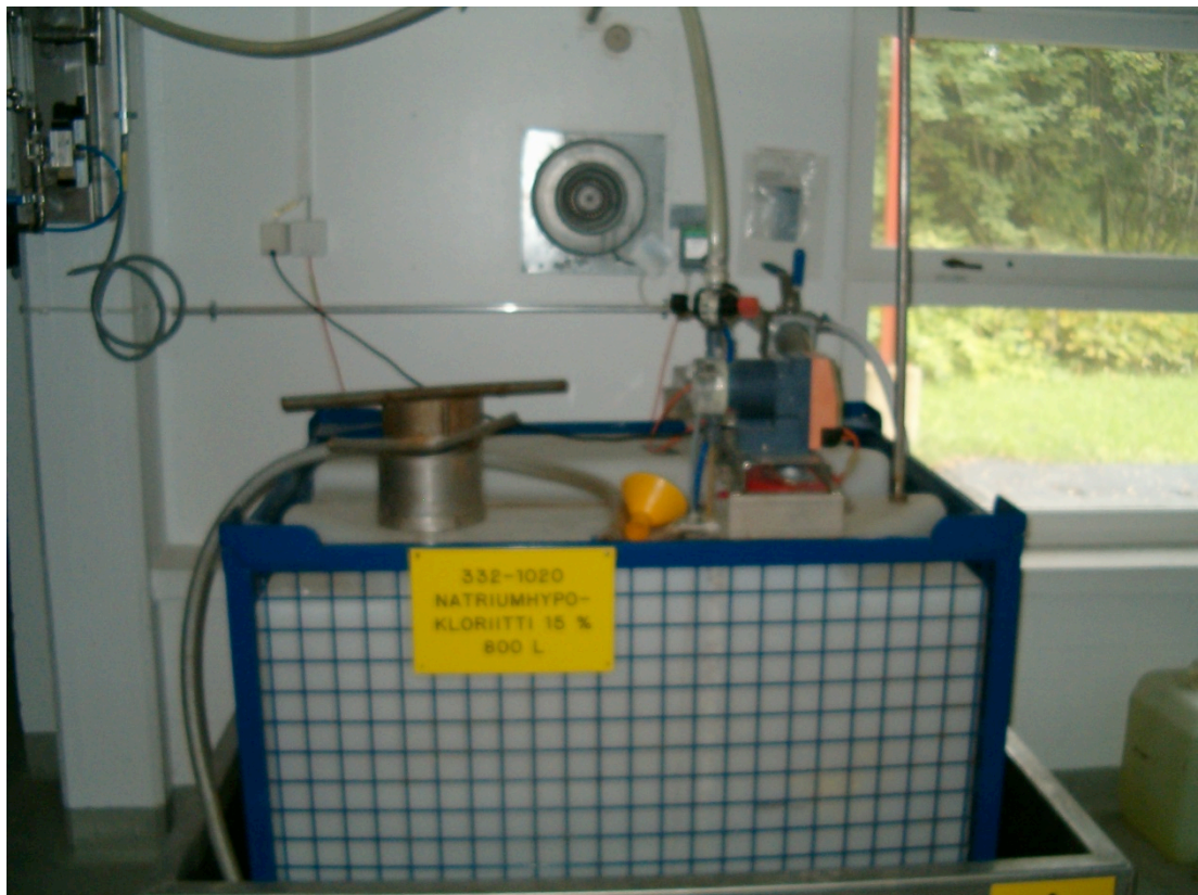
Kuva 6. Natriumhypokloriittisäiliö, sekä annostelupumppu
