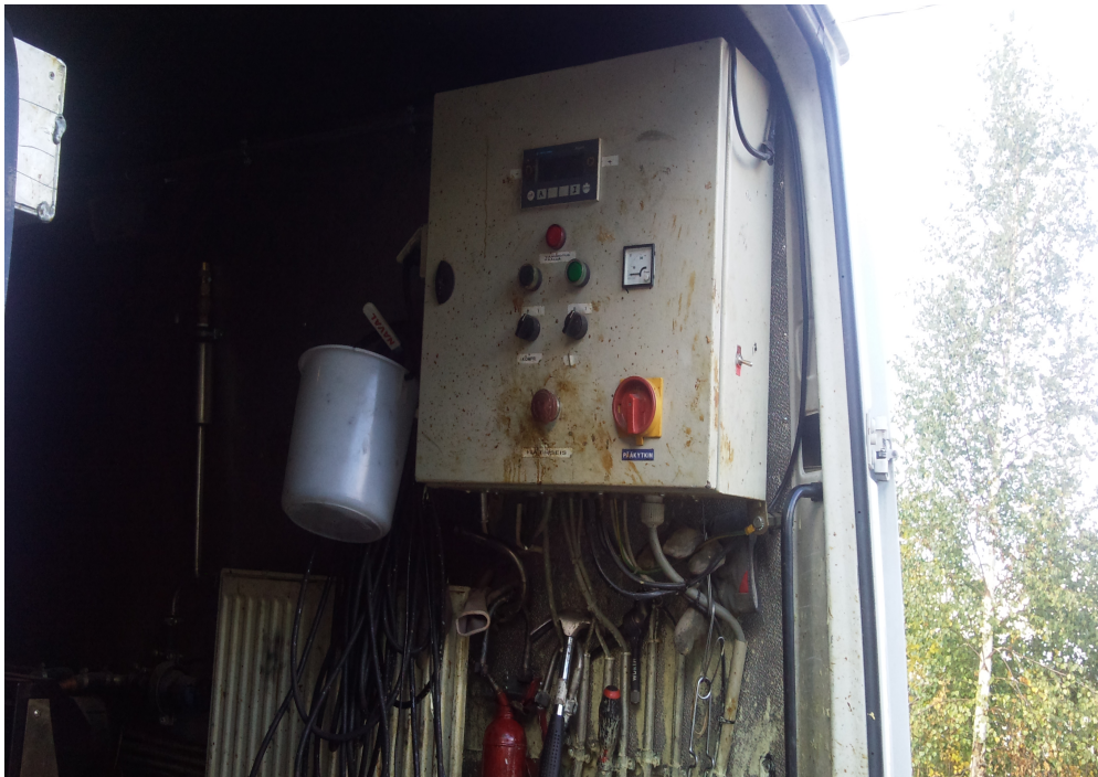
KUVA 9. Koneen sähkökeskus ja käyttökytkimet
