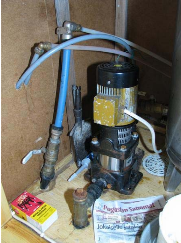
KUVA 17. Käyttövesipumppu. Kuva Joon Vauhkonen
