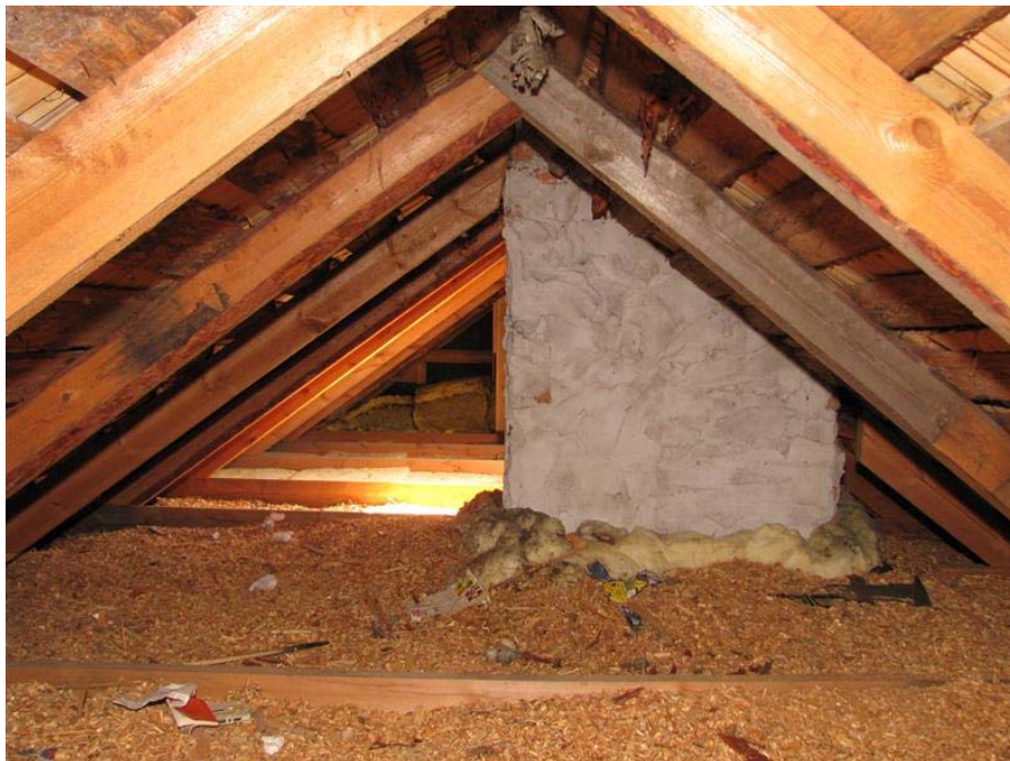
KUVA 5. Yläpohja ja vesikate. Vanhan osan purueristys etualalla ja uuden osan villaeristys takana. Kuva Joonas Vauhkonen
