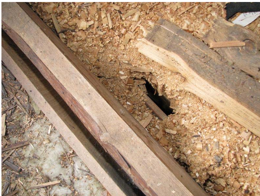
KUVA 6. Yläpohjan ja väliseinän liitos. Yläpohjan purueristys on päässyt valumaan väliseinän sisään. Kuva Joonas Vauhkonen
