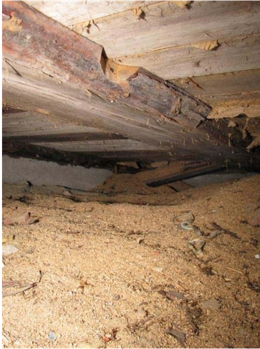
KUVA 2. Ryömintätilainen alapohja. Nurkasta irronnut pohjalauta, jonka seurauksena eriste valunut alapohjaan. Kuva Joon Vauhkonen
