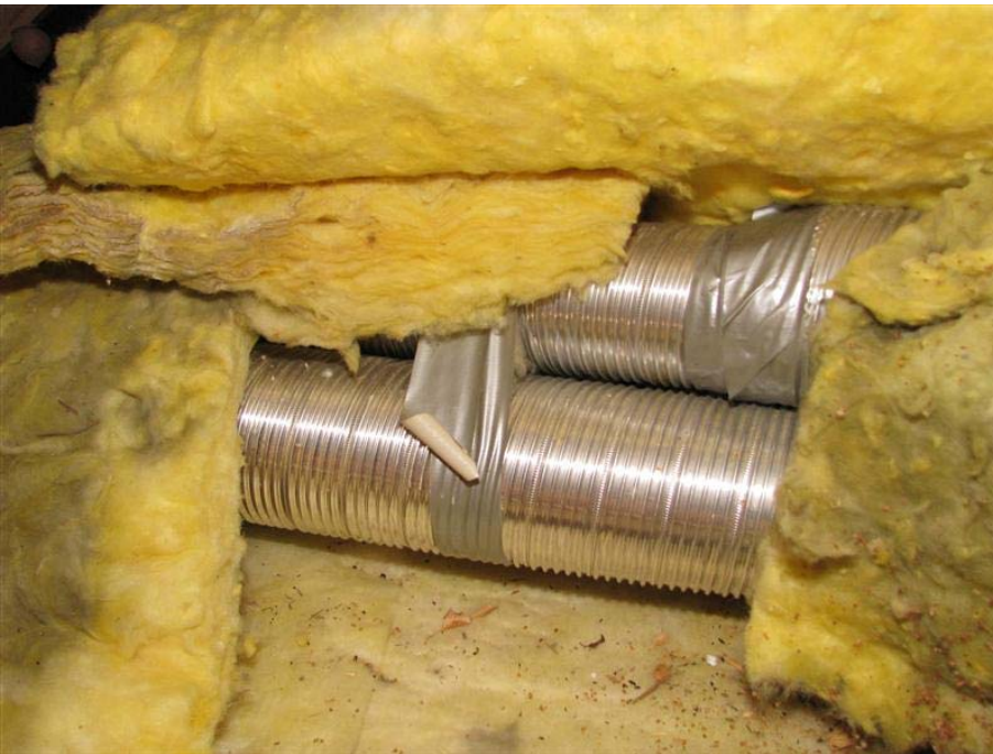
KUVA 14. Ilmanvaihtokanava. Ilmanvaihtokanava menee vaakavetona yläpohjassa, josta se nousee harjan kohdalta vesikatolle. Kuva Joon Vauhkonen
