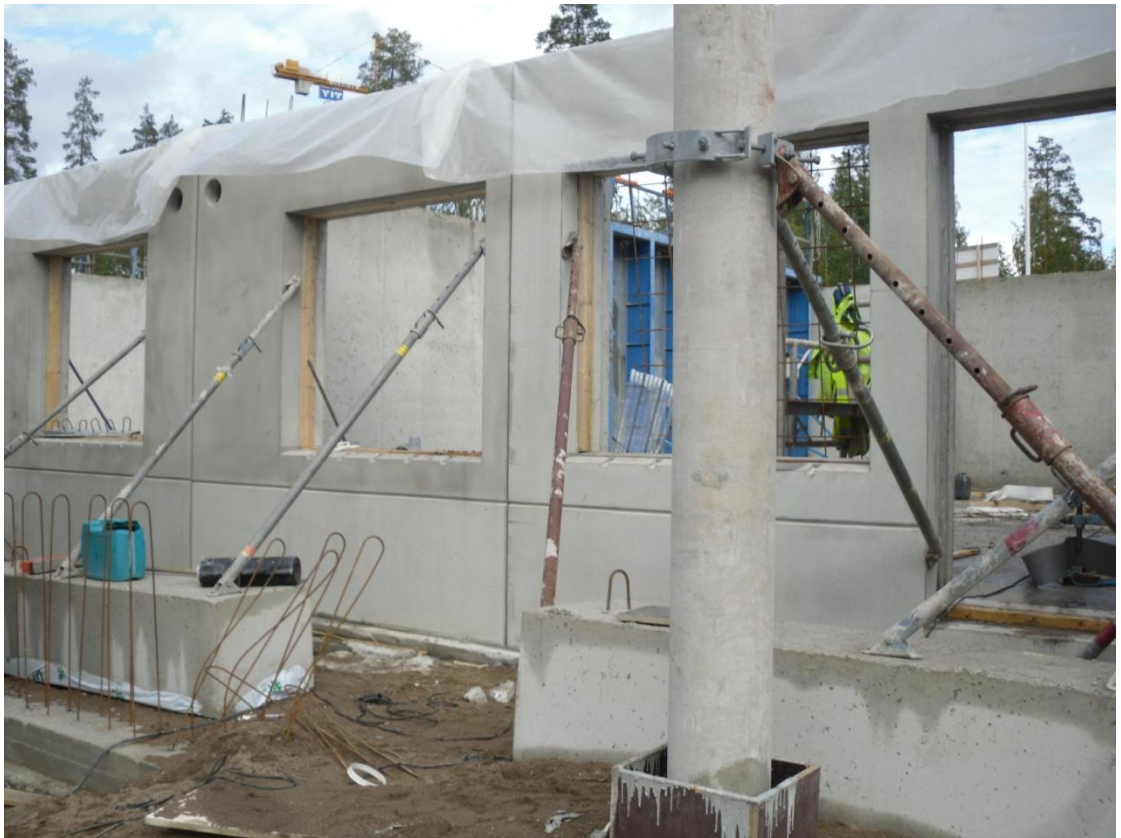
Kuva 10. Elementtien oikeanlainen tuenta. Vähintään 2 kpl vinotukia elementtiä kohden, pilarissa kiinnityksen apuna asennuspanta. Kuva Lauri Alanko.
