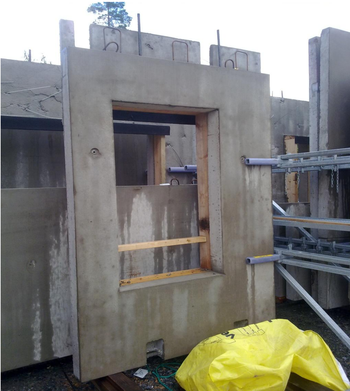
Kuva 16. Ikkuna-aukkojen suojaus tapahtui jo tehtaalla, joten työmaalle jäi yksi suojausvaihe vähemmäksi. Erittäin kätevä tapa hoitaa suojaus, jolloin ei erikseen tarvita suojauksesta vastaavaa henkilöä. Kuva Lauri Alanko.
