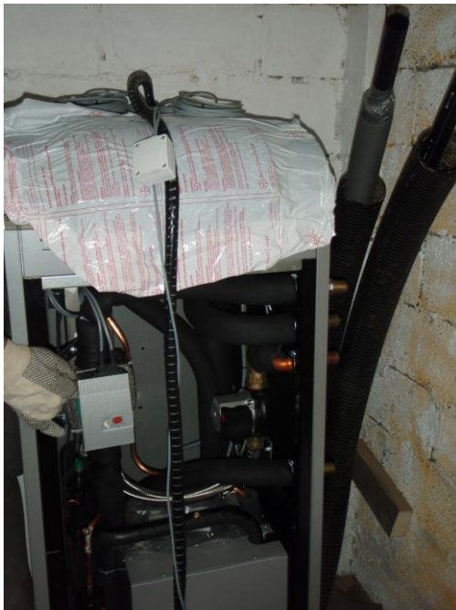
KUVA 16. Lämpöpumppu on merkiltään Oilon Home Geopro GT 11
