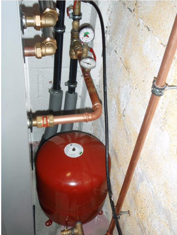
KUVA 21. Paineentasaussäiliöt säätelevät putkien paineita ja kiertävän nesteen nopeutta
