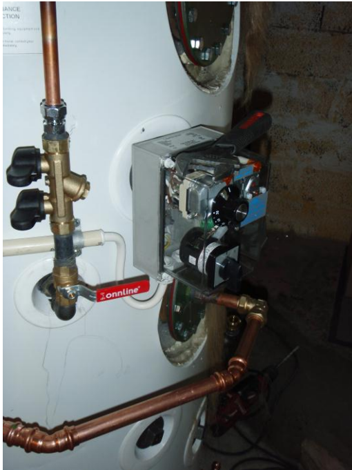
KUVA 20. Vesi saadaan lämmitettyä mahdollisissa häiriötilanteissa myös lämpöparonin avulla
