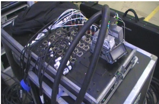
Kuva 22. Toisenlainen analogisen kaukokaapelin kytkentärasia (Kuva: Mia Heinonen)
