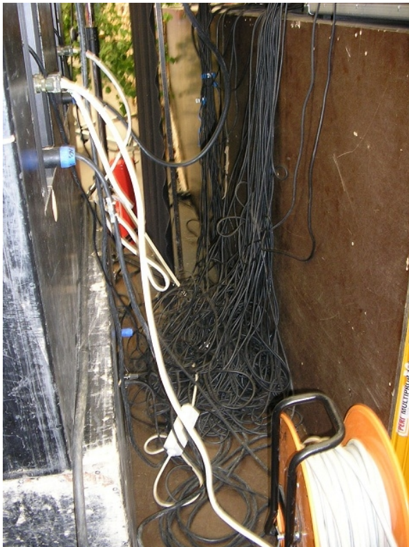
Kuva 45 . Kuvan 44 splitterin alapuoli (Kuva: Mia Heinonen)
