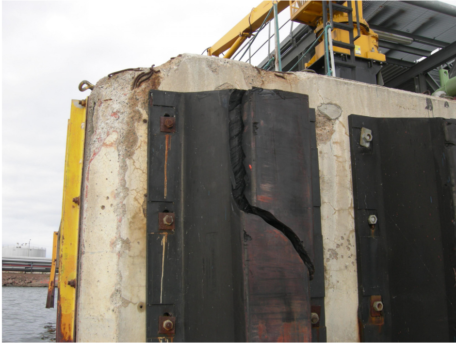
Kuva 23 Aluksen törmäyksen tai hankauksen vuoksi rikkoutunut fenderi (Karvonen 2012.)
