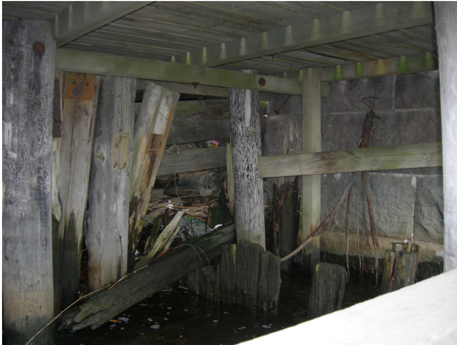
Kuva 18 Lahoamiselle altistuneita puupaaluja (Karvonen 2012.)
