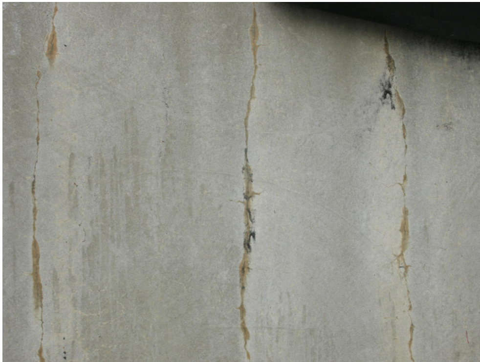
Kuva 21 Pystysuuntaisia kutistumisesta johtuvia halkeamia (Karvonen 2012.)
