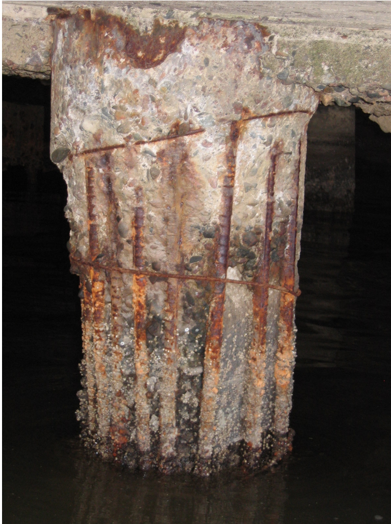
Kuva 19 Betonin rapautumista ja terästen korroosiota kannen alla olevassa kantavassa rakenneosassa (Helsingin satama 2012.)
