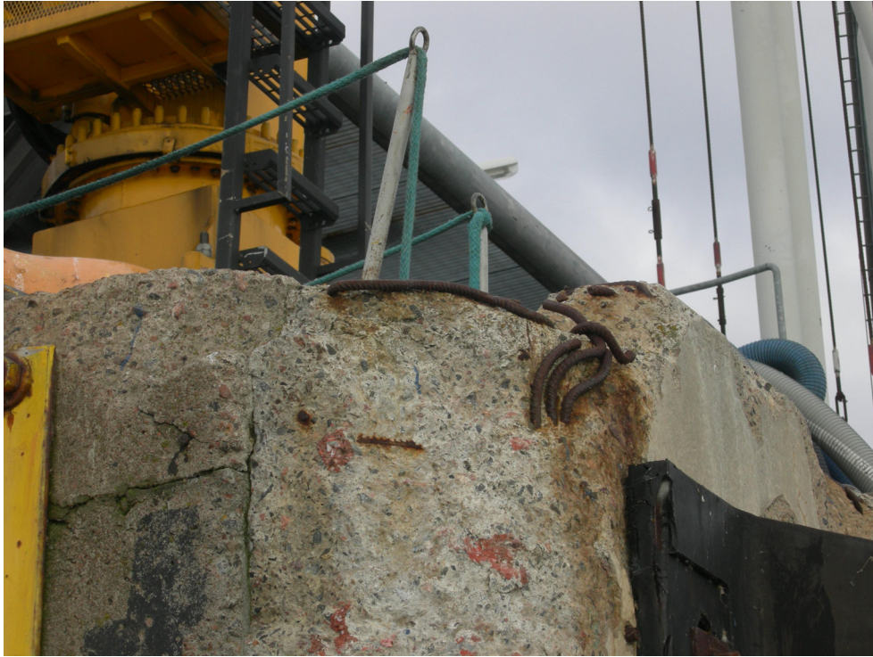
Kuva 20 Betonin rapautumaa ja lohkeilua sekä betoniterästen korroosio kansirakenteen reunamuurissa (Karvonen 2012.)
