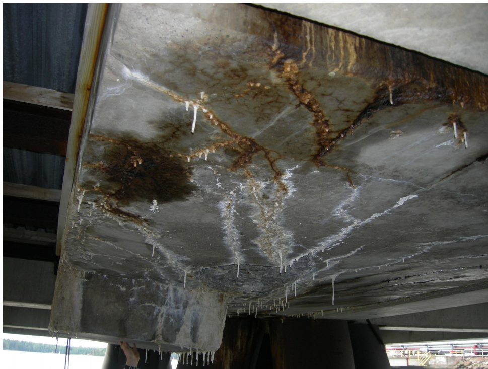
Kuva 22 Pumppauskaivon pohjassa esiintyvää rapaamaa, halkeamia sekä kalkki- vuotoa rakenteen läpi (Karvonen 2012.)
