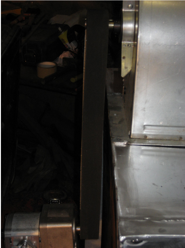
Kuva 11. Hydraulimoottorin ja puhaltimen välinen hihna
