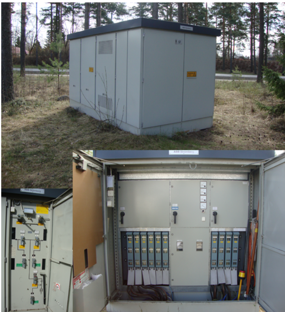
Kuva 2. Vähärauman kampuksen muuntamo. Yläjännitepuoli ja alajännitepuoli (oik.)
