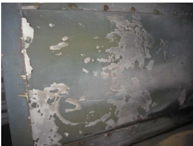
Kuva 12. Tunnelin vasemman kyljen iskettymät
