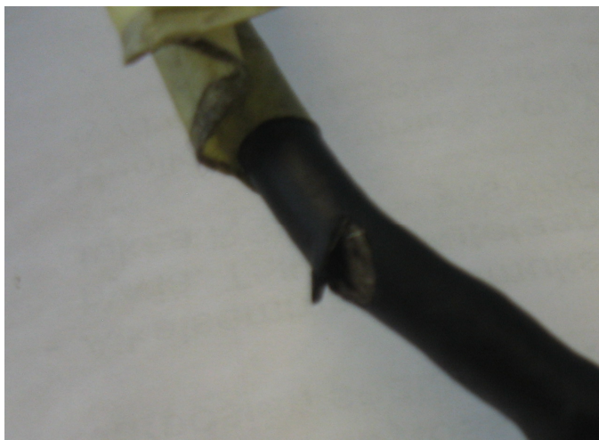
Kuva 8. Syvälle ulottuva kaapelivaurio
