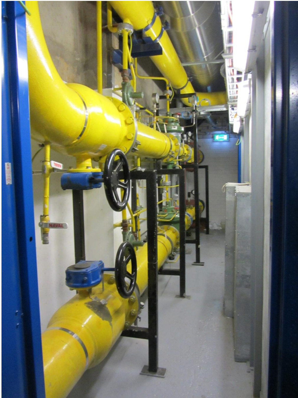
Kuva 18. Maakaasulinjasto turva- ja säätölaitteistoineen.
