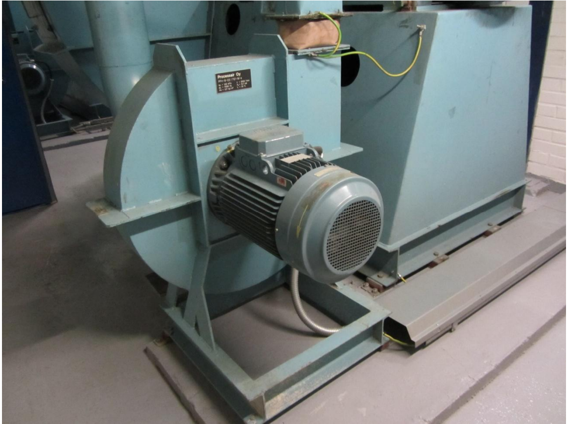
Kuva 16. Kattilan 4 hajotusilmapuhallin ja sen moottori.
