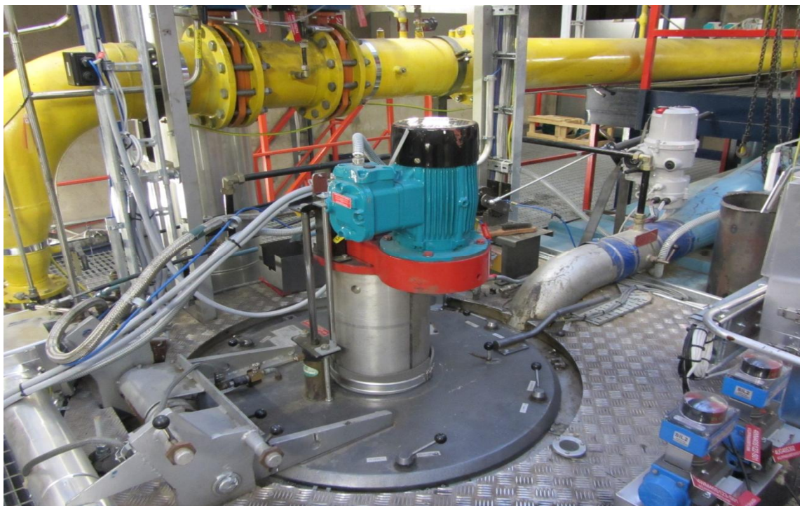
Kuva 11. Edessä poltin päältä kuvattuna ja taustalla maakaasuputkisto.
