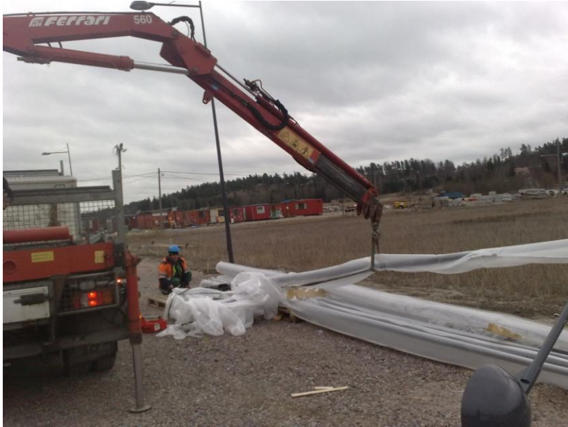
KUVA 16. Maalatut pylväät olivat suojapusseihin pakattuna toimitettu ensin varastolle, ja sieltä asentajan toimesta työmaalle
