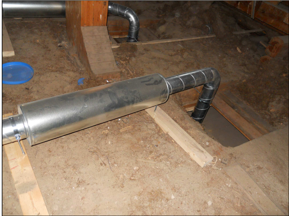
Kuva 25. Katon läpi huoneisiin johdettu kanava äänenvaimentimiseen
