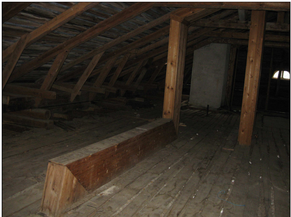
Kuva 3. Ullakon vanhat ilmanvaihtohormit
