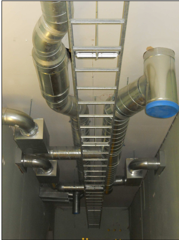
Kuva 21. Käytävälle sijoitettuja ilmanvaihtokanavia, joista on tehty läpiviennit huoneisiin.
