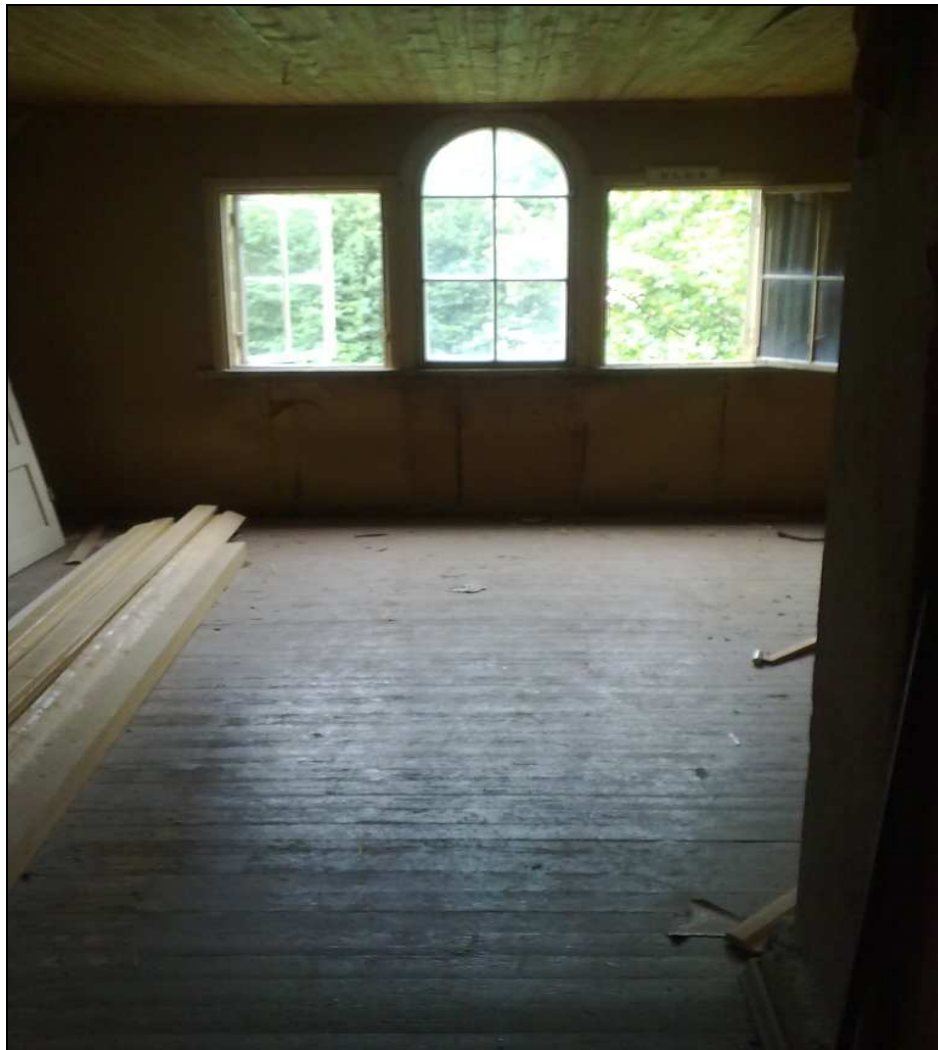
Kuva 14. Tuleva iv- konehuone ullakolla
