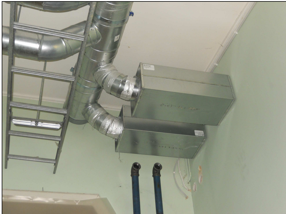
Kuva 23. Sivuseinistä huoneisiin johtaviin kanaviin asennetut äänenvaimentimet
