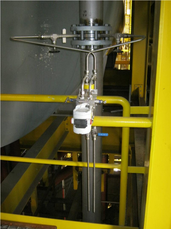
Kuva 6: Virtausmittaus AF02 käytännössä ilman kaapeleita (Pitkänen 2011)
