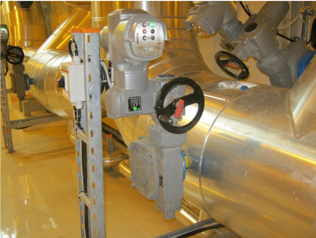
Kuva 7: Moottoriventtiili AV15_1 käytännössä (Pitkänen 2011)
