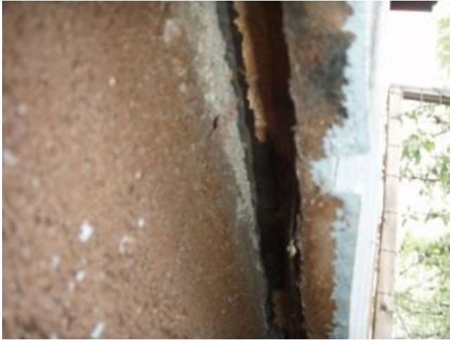
KUVA 7. Ulkoseinän ilmarako puuttuu (Tissari 2011)
