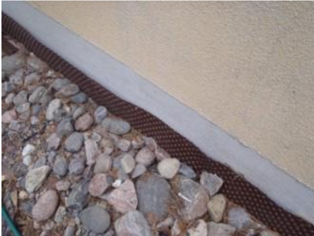
KUVA 4. Perusmuurilevyn ylälista puuttuu (Tissari 2011)
