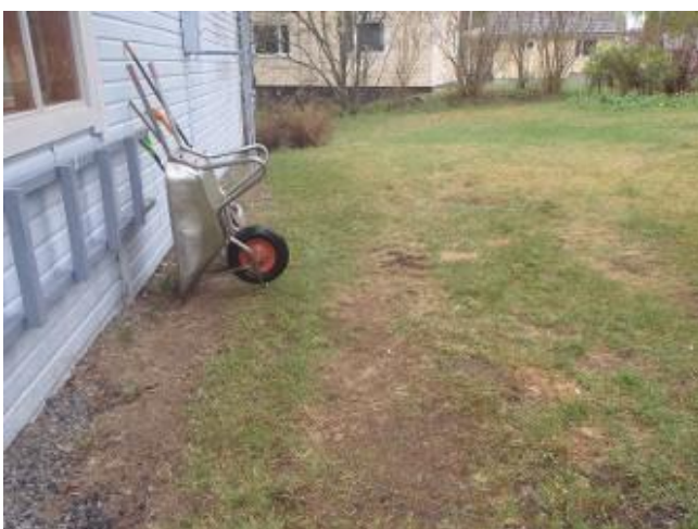
KUVA 3. Rakennuksen viereinen maanpinta viettää sokkeliin päin (Tissari 2011)
