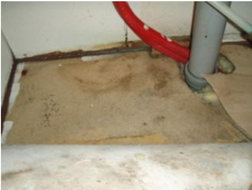
KUVA 3. Keittiön lattian kosteus- ja homevaurio (Tissari 2011)
