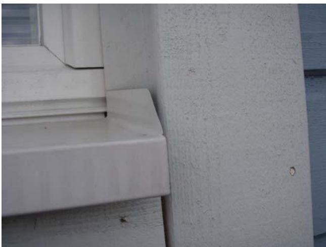
KUVA 24. Vesipellin tiivistys karmiin puutteellinen (Tissari 2011)
