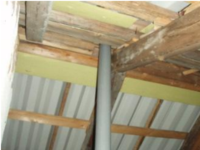
KUVA 16. Yläpohjassa oleva putki eristämättä (Tissari 2011)
