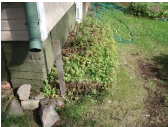
KUVA 2. Sadevesikaivo puuttuu (Tissari 2011)
