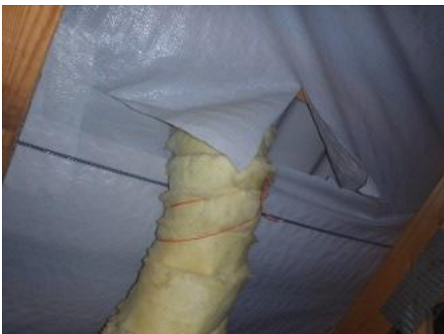
KUVA 21. Aluskatteen läpivienti puutteellinen (Tissari 2011)
