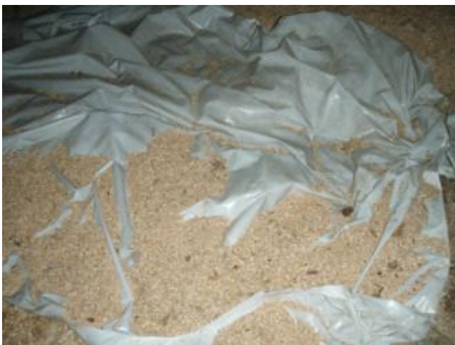
KUVA 12. Yläpohjan eristeen päälle jätetty muovi (Tissari 2011)
