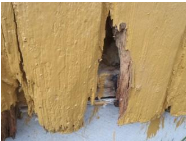
KUVA 8. Ulkoseinän lahovaurio (Tissari 2011)
