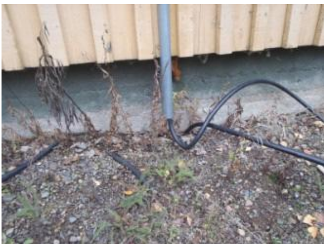
KUVA 27. Maastanouseva kaapeli suojaamatta (Tissari 2011)
