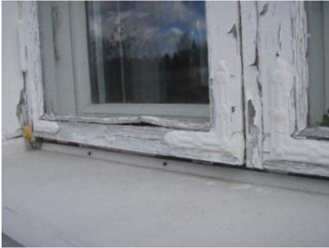
KUVA 22. Ikkunan maalipinta hilseilee (Tissari 2011)
