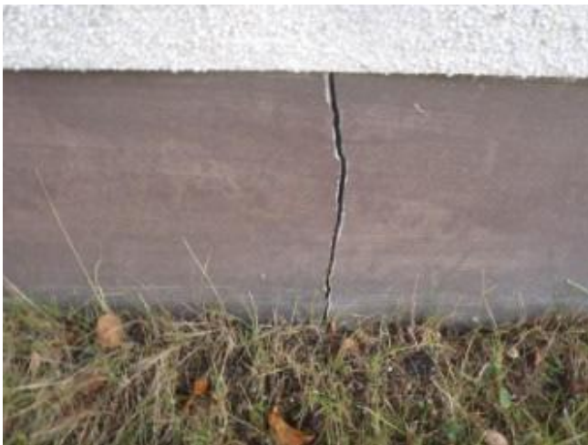
KUVA 5. Sokkelin halkeama (Tissari 2011)
