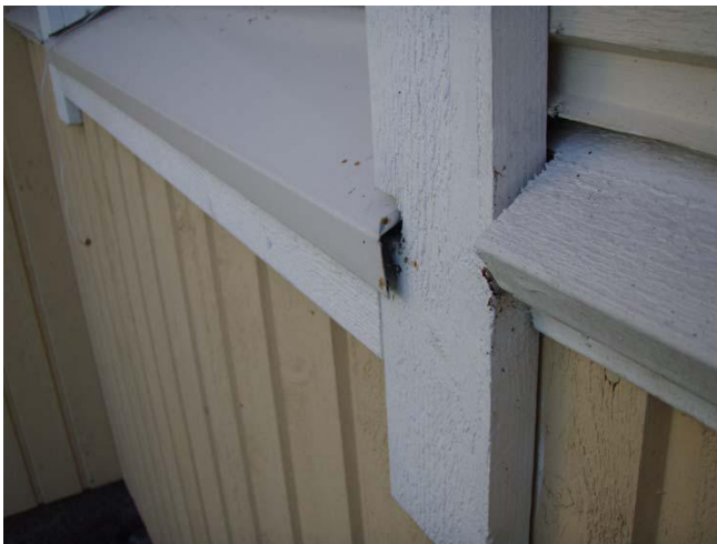
KUVA 23. Vesipellin ylitys seinälinjasta liian pieni (Tissari 2011)
