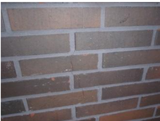
KUVA 9. Tiiliseinän halkeama (Tissari 2011)
