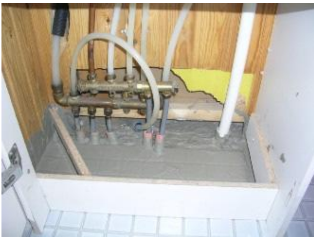
KUVA 26. Käyttöveden jakotukki kannakoimatta seinään (Tissari 2011)
