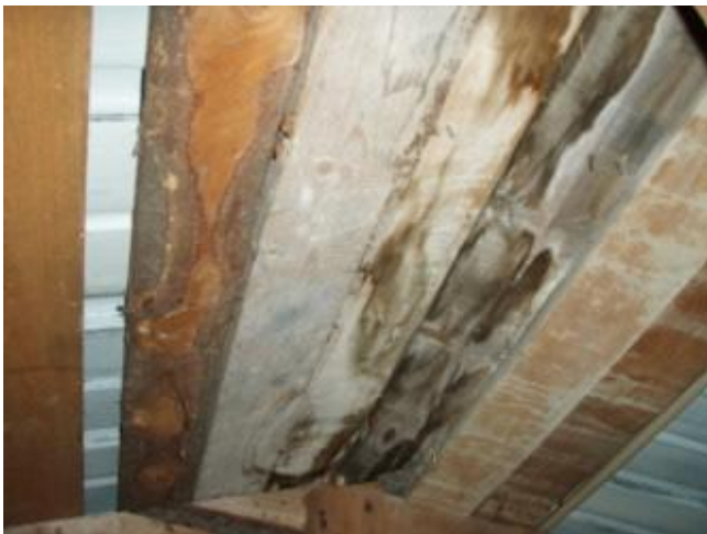
KUVA 11. Yläpohjassa vuotojälkiä (Tissari 2011)
