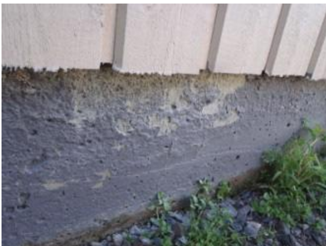
KUVA 6. Sokkelin maalipinta hilseilee (Tissari 2011)
