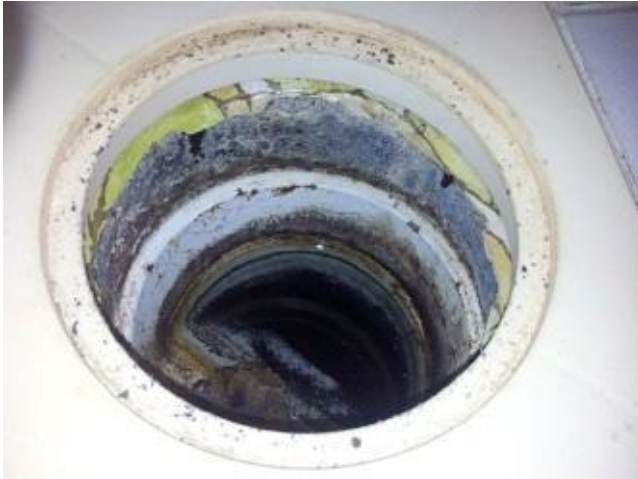
KUVA 25. Lattiakaivon tiivisteet puutteelliset (Tissari 2011)
