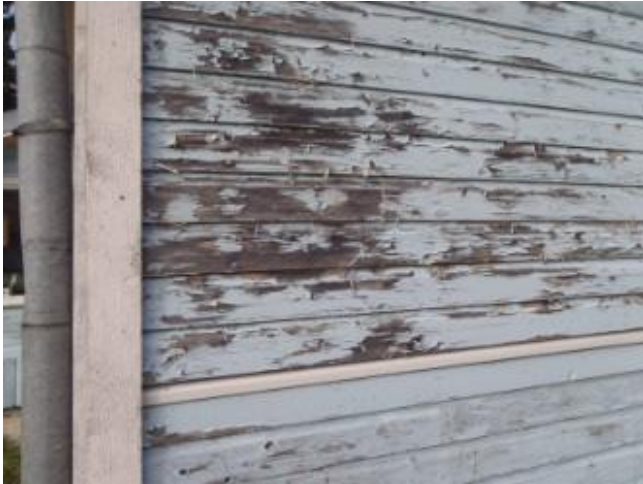
KUVA 10. Ulkoseinän maalipinta hilseilee (Tissari 2011)
