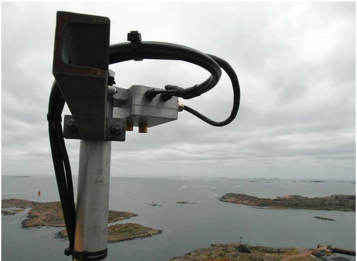
Kuva 4. Utön saarella rakenteilla olevan pitoisuusmittausaseman imulinjan pää; Utössä imulinja ulottuu 60 metriä korkean telemaston huippuun
