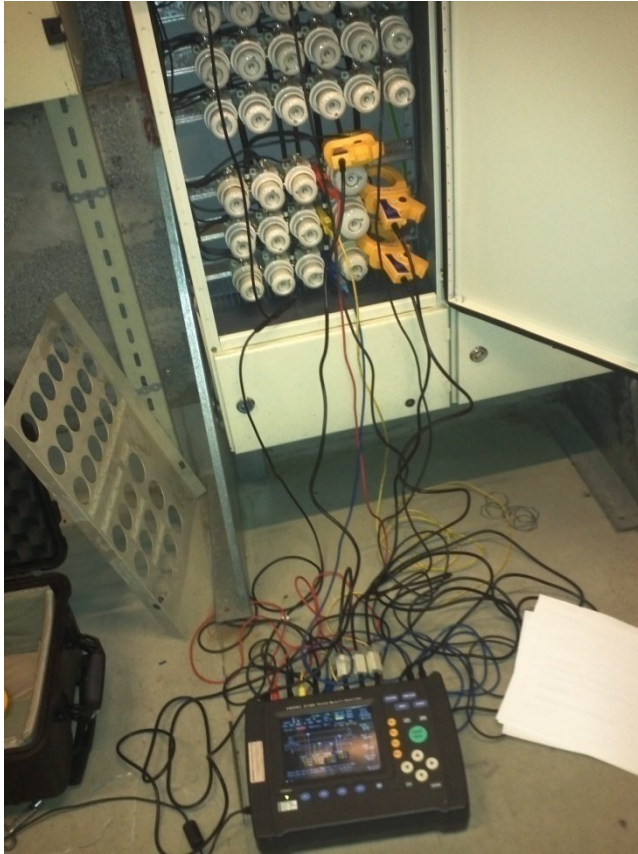
Kuva 10. Sähkönottotehon mittausta Hioki 3196 -tehoanalysaattorilla.
