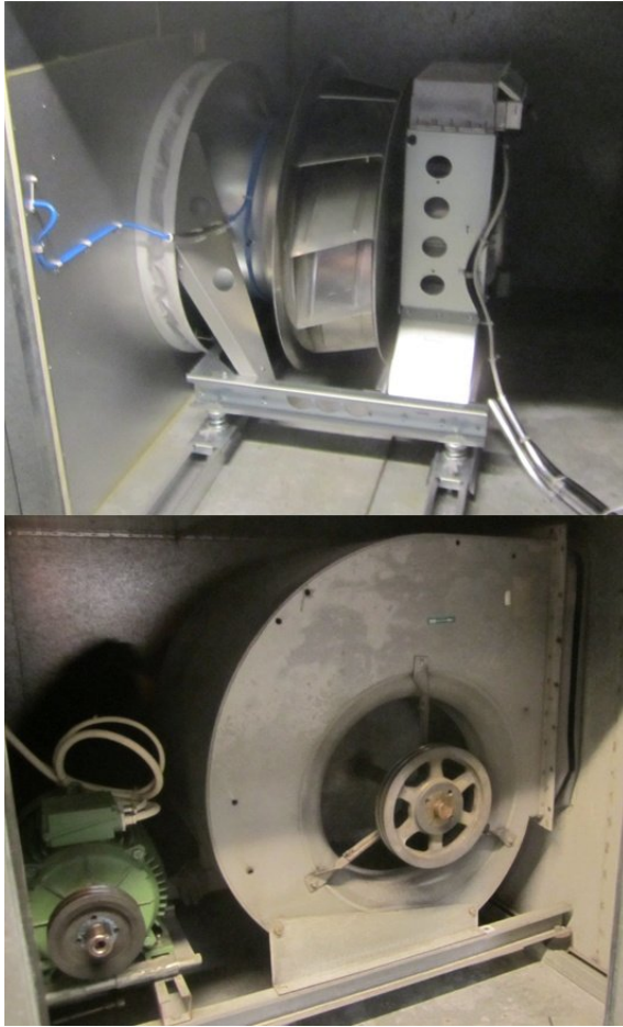
Kuva 8. Uusi ja vanha tulopuhallin.
