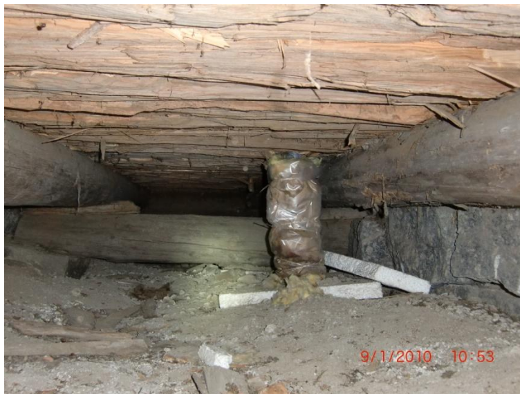
Kuvio 3. Vanhan liikerakennuksen ryömintätilaa. Kivisokkeli on ulkopuolelta pellitetty ja sokkeliin on jätetty vain muutama tuuletusreikä. Tuuletusreiästä tarkastettaessa ryömintätilan puurakenteet ovat silmämääräisesti tarkastelemalla kunnossa.
