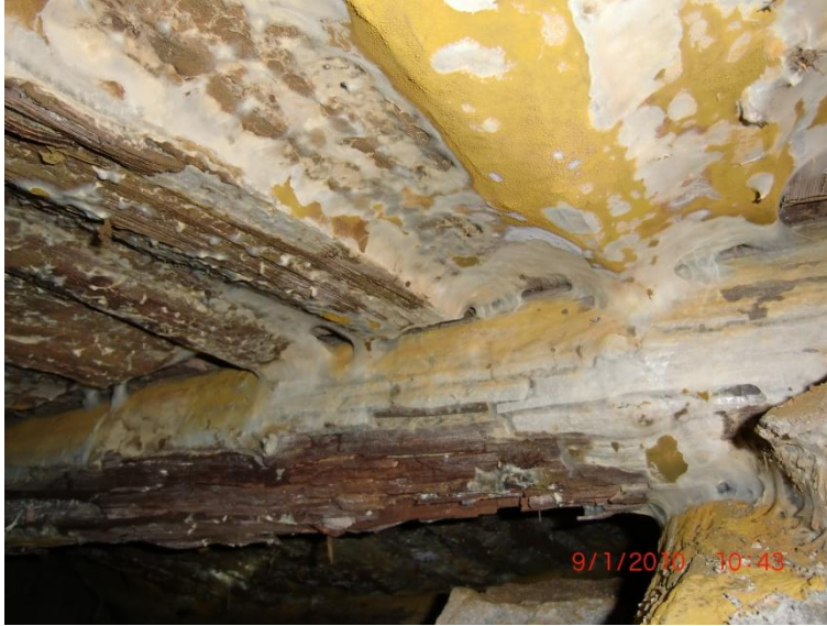
Kuvio 4. Edellisen kuvan ryömintätilan piiloon jäävässä osassa, jonne ei ollut pääsyä rakenteita avaamatta, todettiin vakava, laajalle levinnyt mikrobivaurio.
