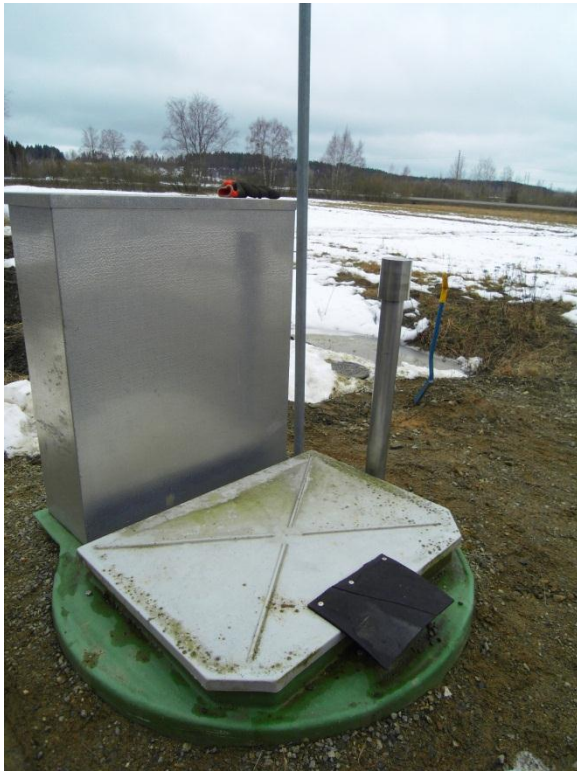
KUVA 12. Sikalanmäen pumppaamo. (Kuva: Jussi Tukeva 2012)
