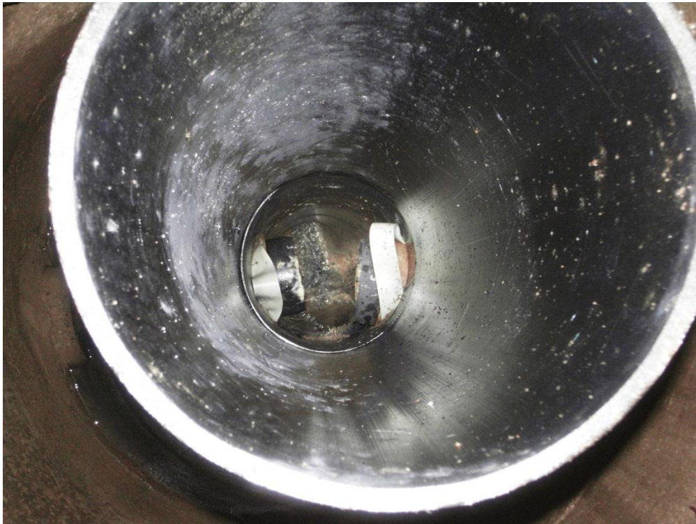
KUVA 13. Vuotava liitos saneeratulla viemäriosalla. (Kuva: Jussi Tukeya 2012)
