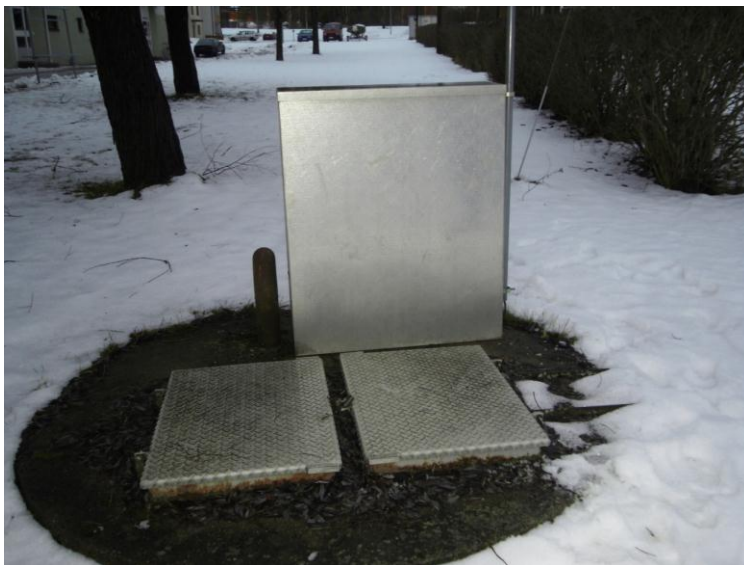
KUVA 10. Reikontien pumppaamo. (Kuva: Jussi Tukeva 2011)
