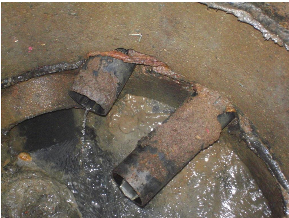
KUVA 21. Putkiliitoksista vuotava kaivo. (Kuva: Jussi Tukeya 2012)
