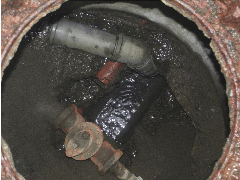
KUVA 18. Viemäriä, vesijohtoa ja salaojaa sisältävä kaivo. (Kuva: Jussi Tukeva 2012)
