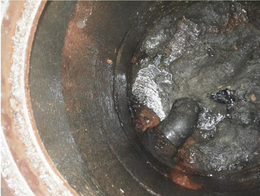
KUVA 17. Ylipytingintien huonokuntoinen kaivo. (Kuva: Jussi Tukeya 2012)
