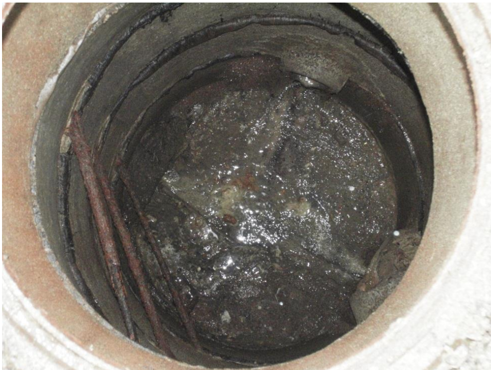
KUVA 16. Rinnetien saneeraamaton kaivo. (Kuva: Jussi Tukeva 2012)
