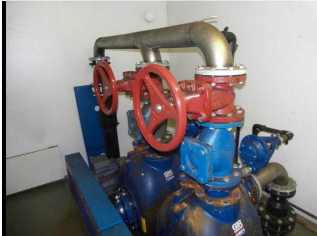
KUVA 8. Uutisjärven pumppaamon koneisto. (Kuva: Jussi Tukeva 2011)
