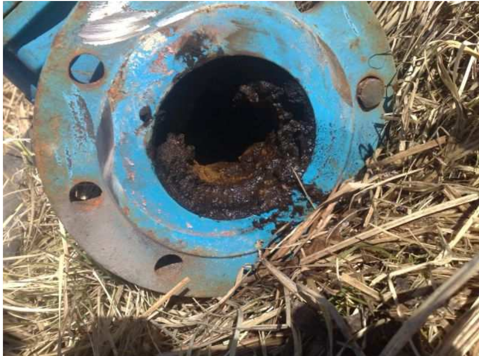
Kuva 3 Kertynyttä saostumaa epoksinnoitetussa valurautaisessa venttiilissä.
