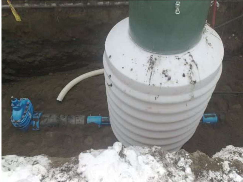
Kuva 10 Virtausmittauskaivo Hämeenlinnan Vanajantiellä.
