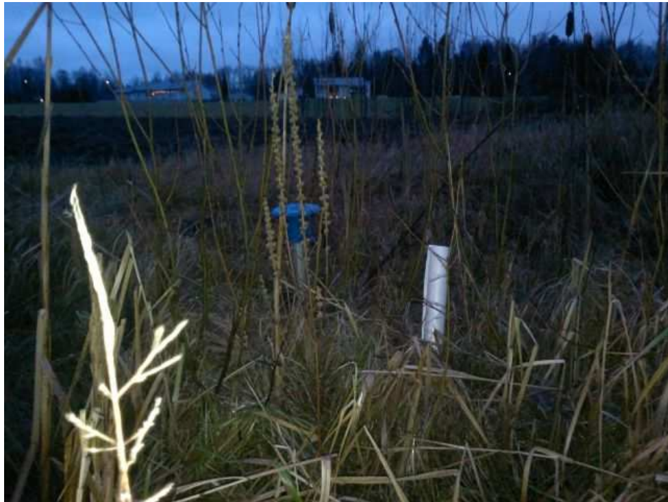
Kuva 9 Hoitamattomilla alueilla venttiilit jätetään maanpintaa selkeästi korkeammalle.
