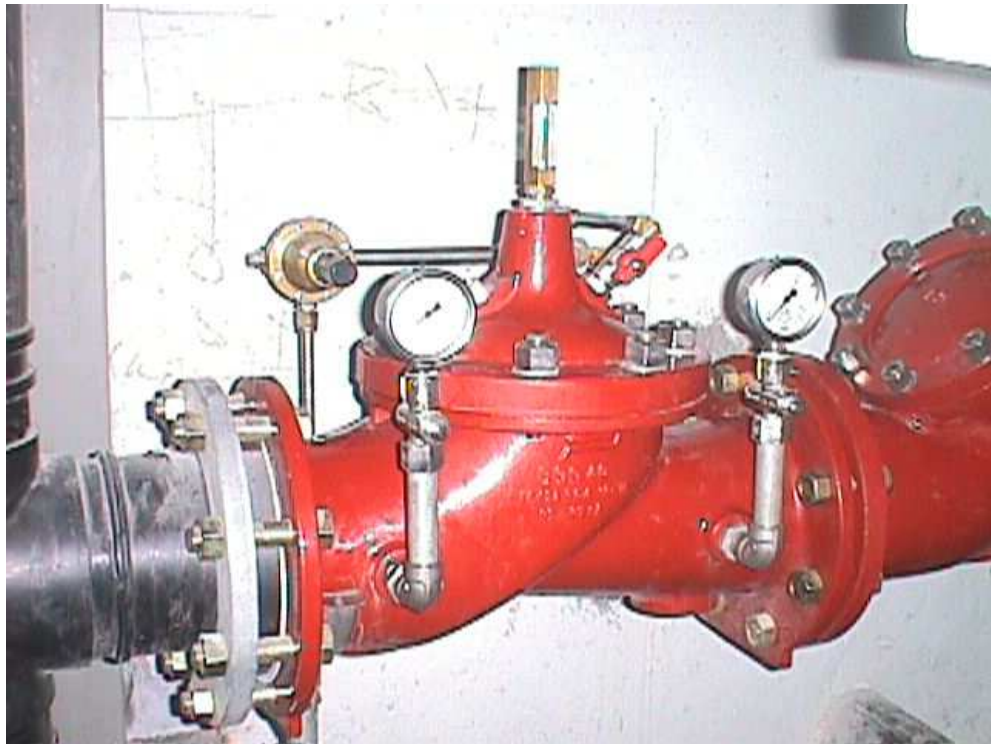
Kuva 12 Omavoimainen säätöventtiili paineenalennusvarustuksella.
