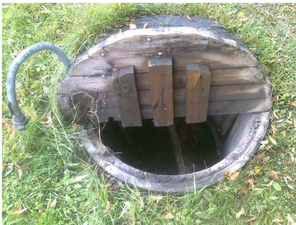
Kuva 5 Viheralueella oleva vaarallinen kaivonkansi.
