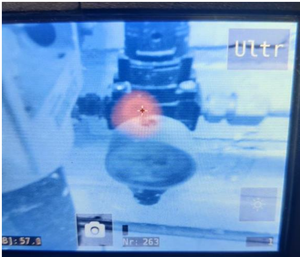
KUVA 10. Havainnollistava kuva painemittarin vuodosta.
