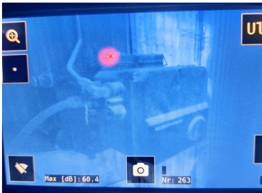
KUVA 9. Automaattiventtiin toimilaitte vuotaa tiivistepinnan välistä.
