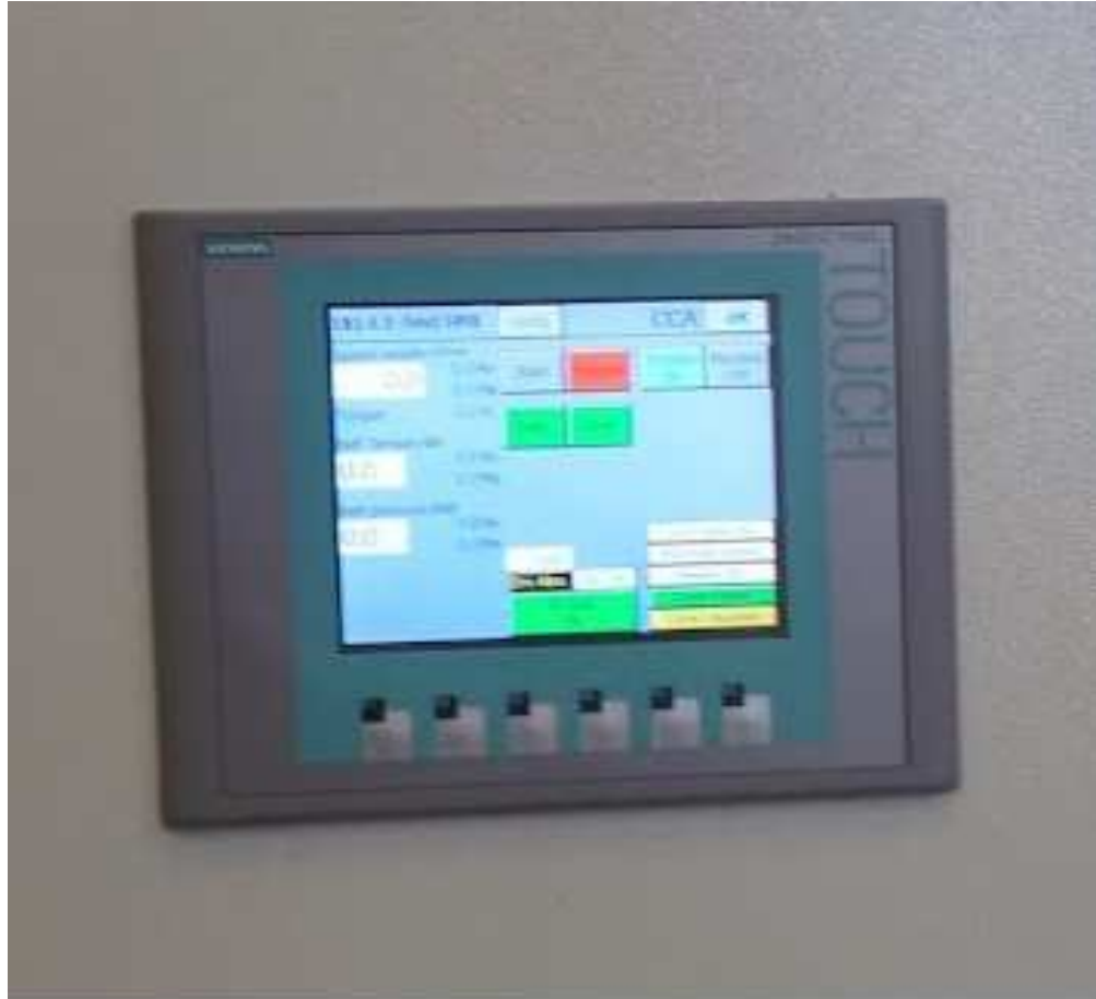
KUVA 2. HMI-kosketusnäyttö on upotettu koestuspaneelin sähköohjauskotelon oveen.
