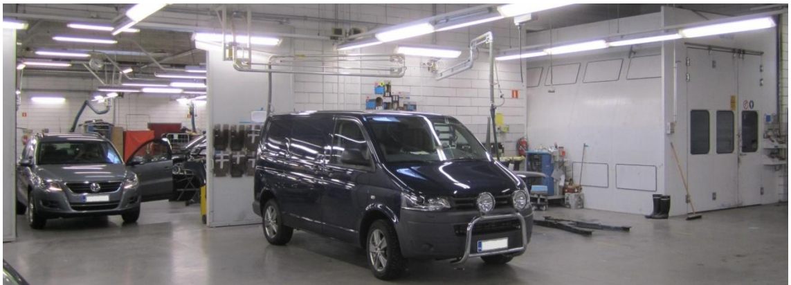
KUVA 7. Kantatalon maalauskammiot sekä korjaamon ja maalaamon välinen läpikulkuvi maalaamon puolelta katsottuna (Kuva: Vesa Vuohtoniemi 2012, muokattu)
