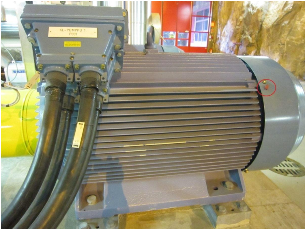
Kuva 9. Värähtelymittausnasta kaukolämpöpumpun moottorissa.
