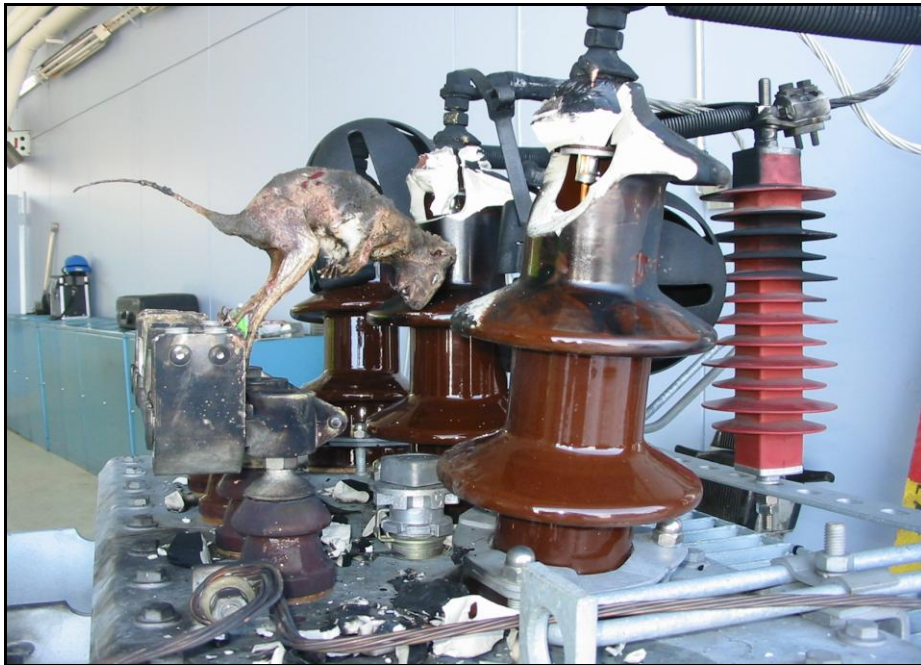
Kuva 11. Oravan aiheuttama oikosukutilanne muuntajan kannella
