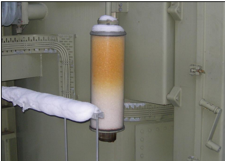
Kuva 18. Erään sähköaseman suurmuuntajan kosteudenpoistopatruuna
