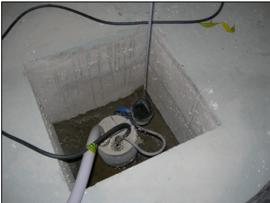
Kuva 19. Erään sähköaseman kellarin turvahälytyksen antava anturi
