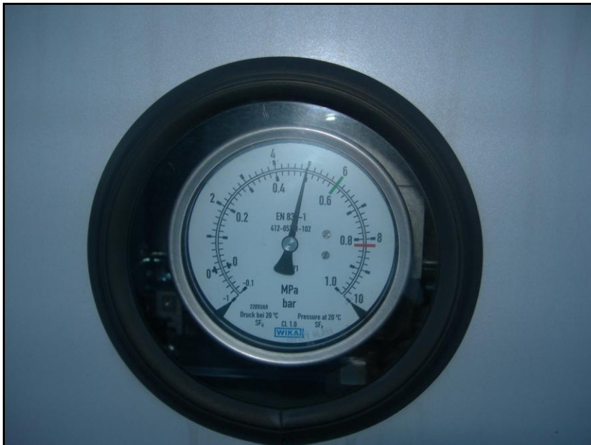
Kuva 17. Erään kytkinlaitteiston eristekaasun paine.
