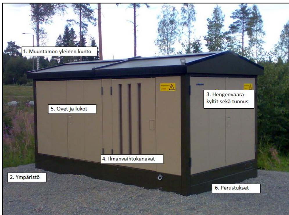
Kuva 13. Tyypillisen puistomuuntamon tarkastuskohteet ulkopuolelta
