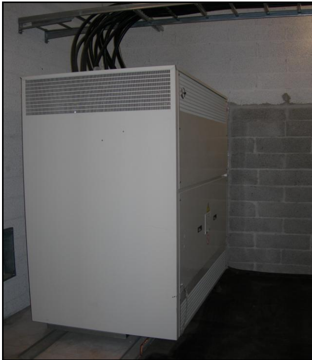
Kuva 15. Erään kiinteistömuuntamon kuivamuuntaja
