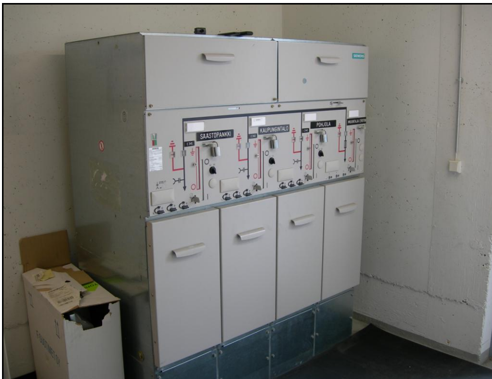
Kuva 16. Erään kiinteistömuuntamon keskijännitepuolen SF6-kytkinkojeisto
